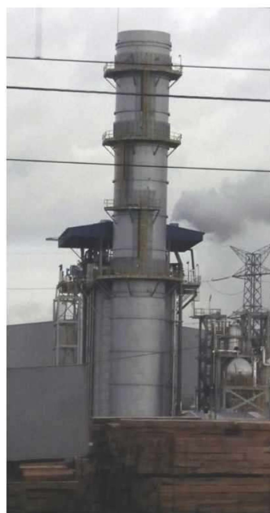
Central térmica de Castejón. FOTO: ALFREDO RUEDA.
