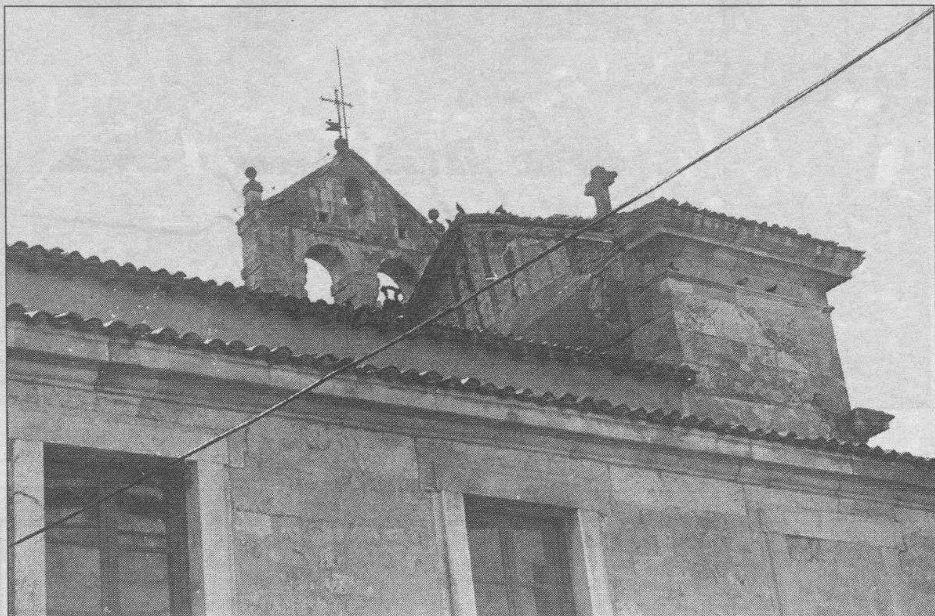
Las cubiertas del convento de las MM. Dominicas necesitan una urgente reparación.
