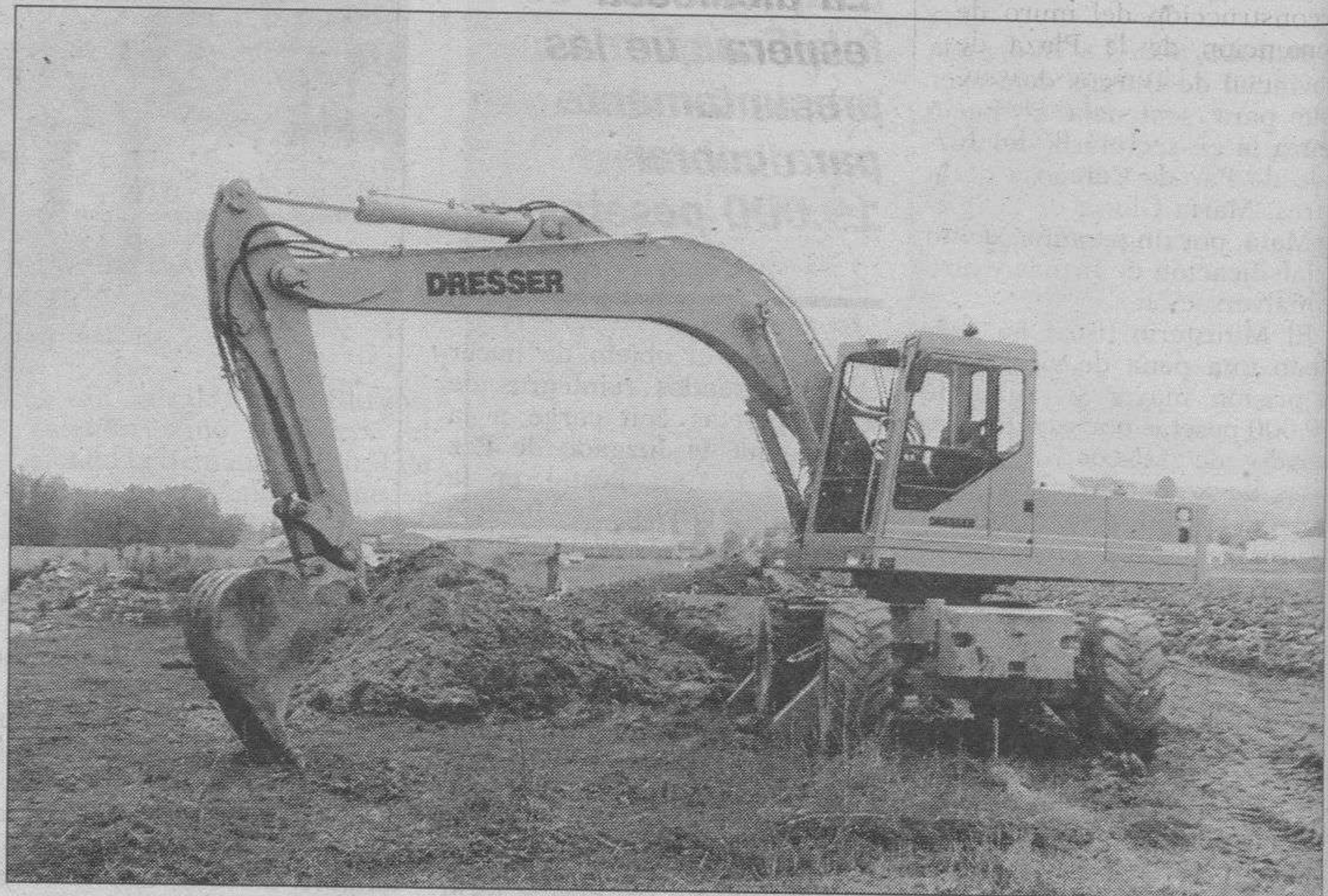
La primera fase contempla la construcción del emisario, que parte del polígono industrial.
