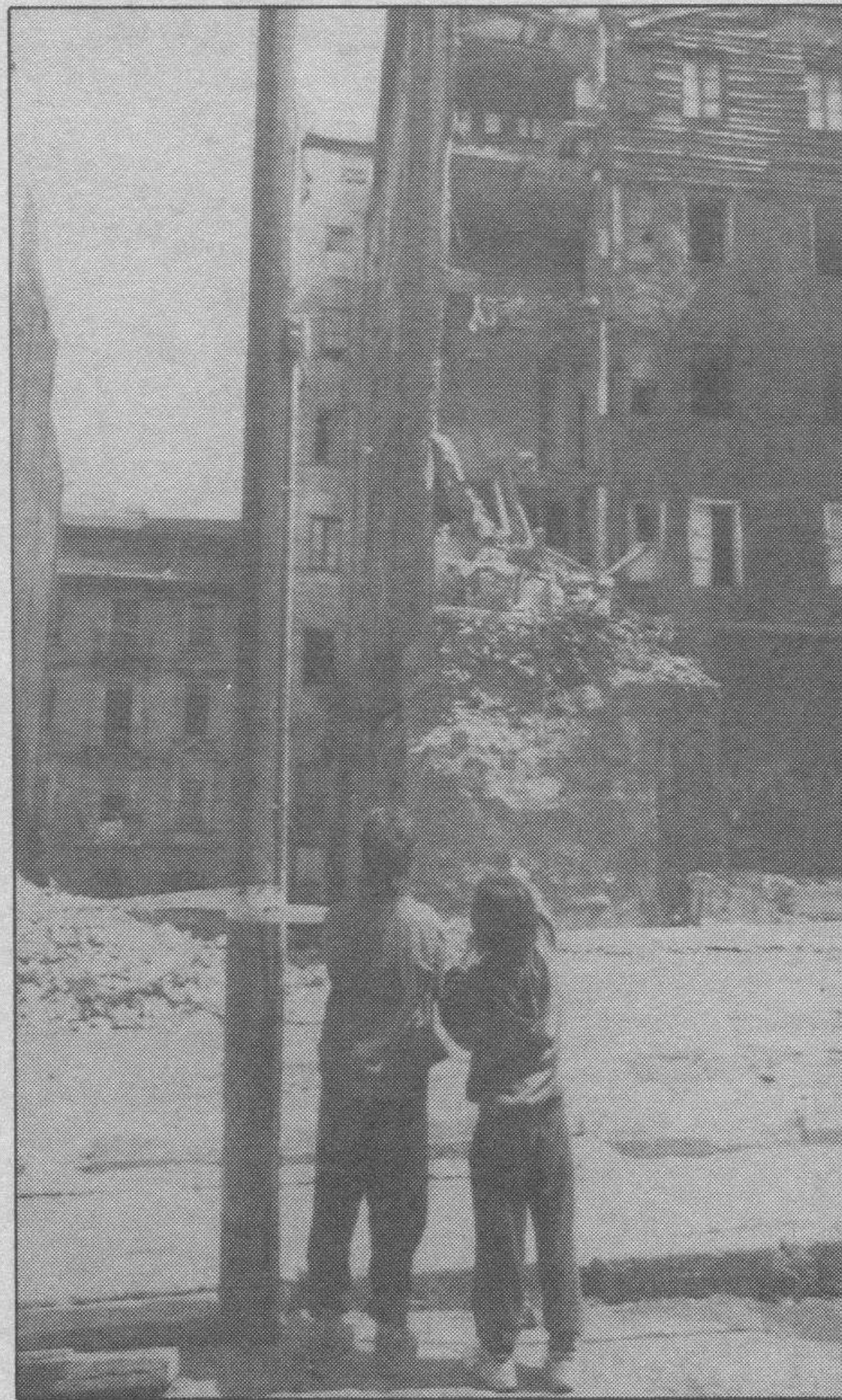
TXEMA FERNANDEZ/EFE Estado en el que quedó el edificio tras el derrumbe
