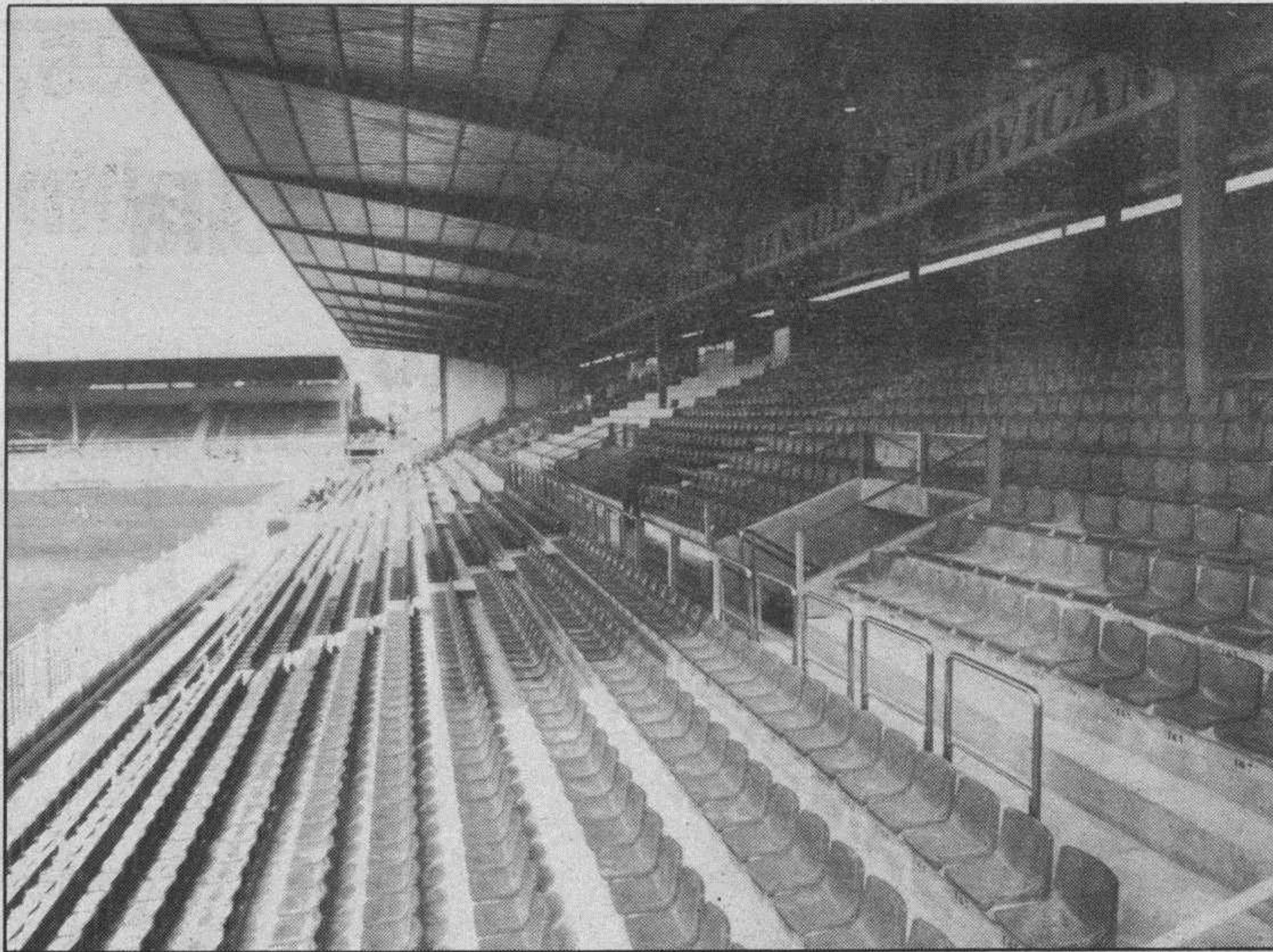
Los asientos de la grada norte pueden ser los causantes de la filtración. (Foto: Jesús Matías).
