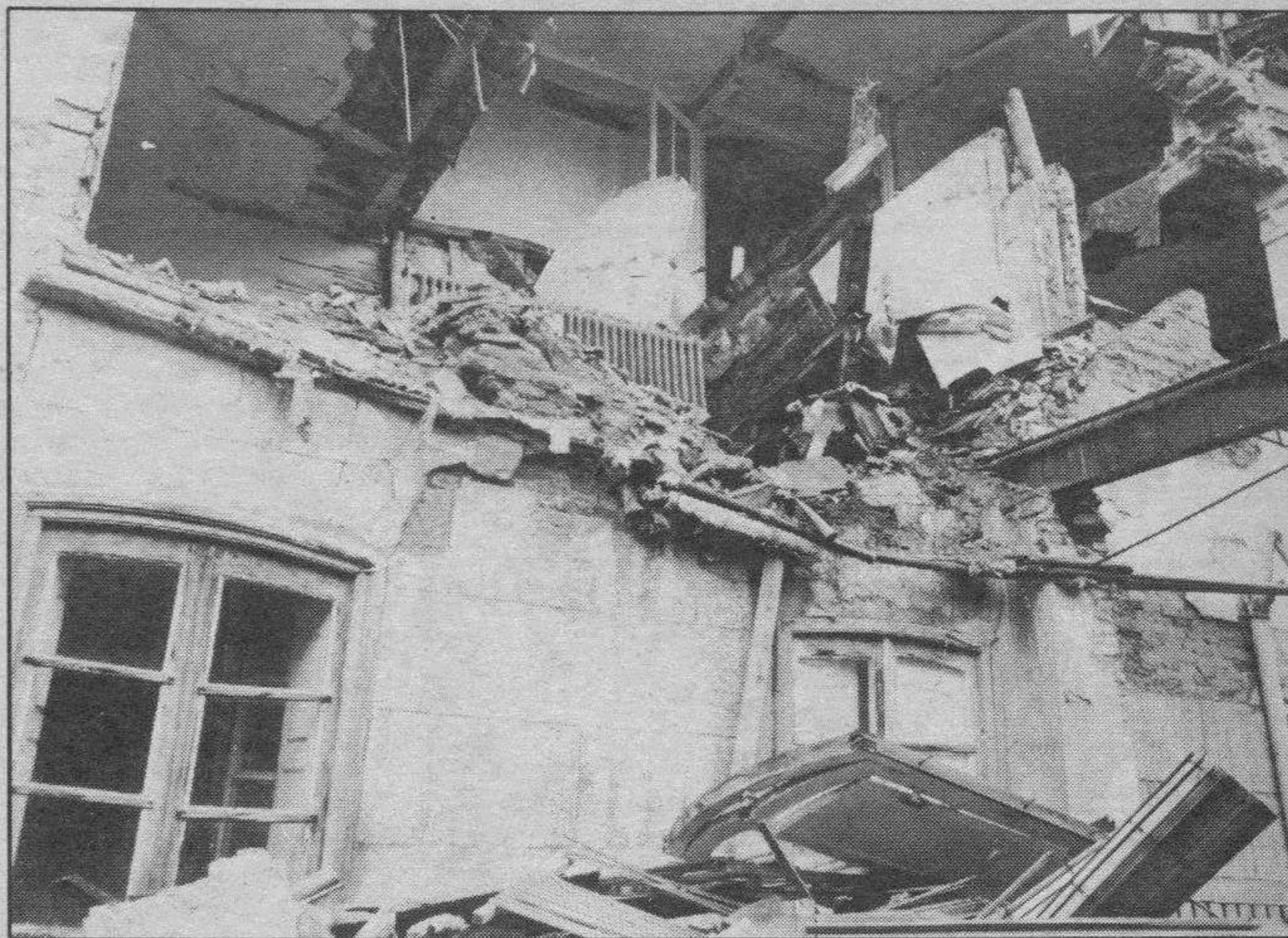
El edificio contiguo al Instituto «Enrique Flórez» se desplomó el martes. (Foto L. Matías).
