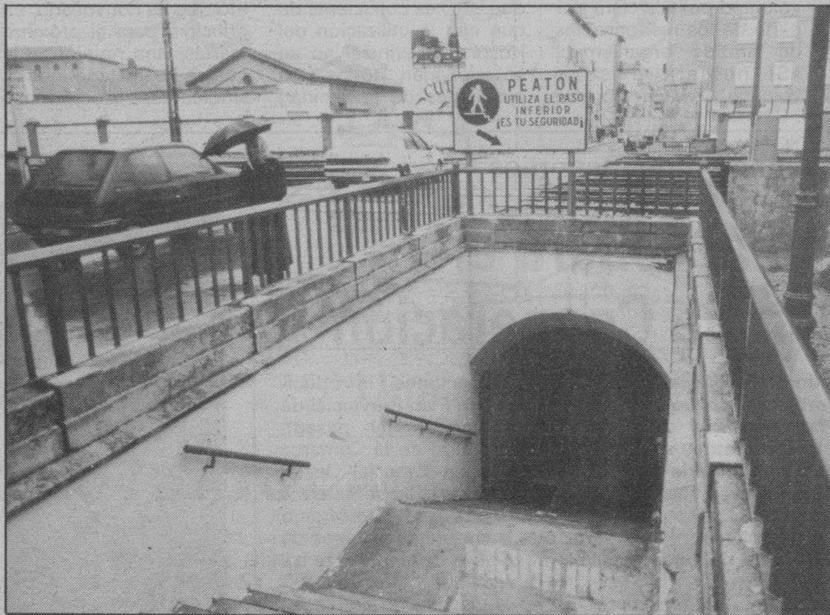
Desde hace casi un mes el paso subterráneo se encuentra sin iluminación. (Foto L. Matías)
