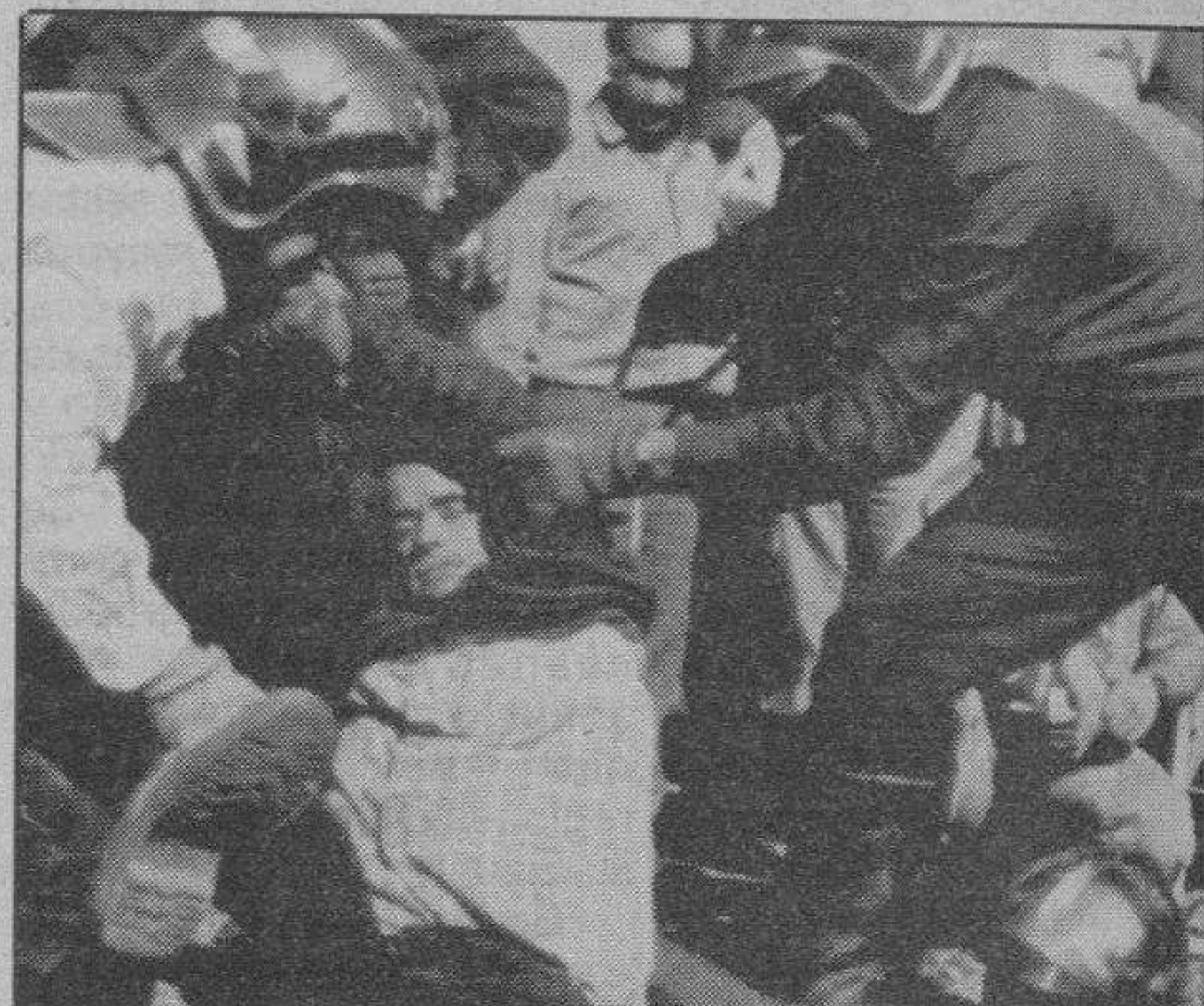
Un hombre moría ayer por la mañana en Borriol (Castellón), al derrumbarse las paredes de una zanja en la que estaba trabajando y quedar sepultado. Casi tres horas se tardó en sacar su cuerpo, momento que recoge la imagen. Efe
