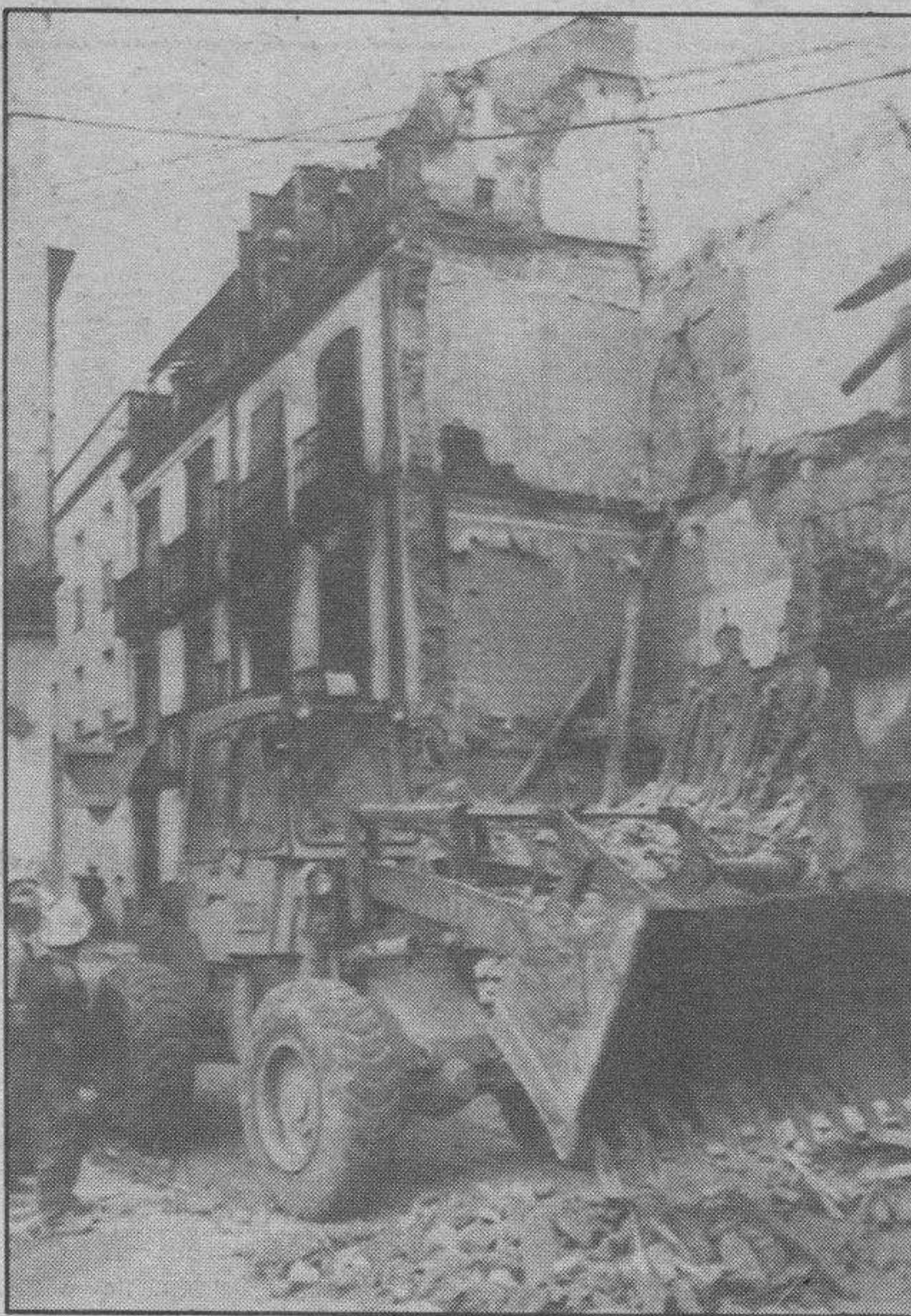
Por segunda vez en dos días, una casa de Sevilla se ha hundido a causa de la lluvia. Uno de los dos heridos tiene lesiones graves. Efe
