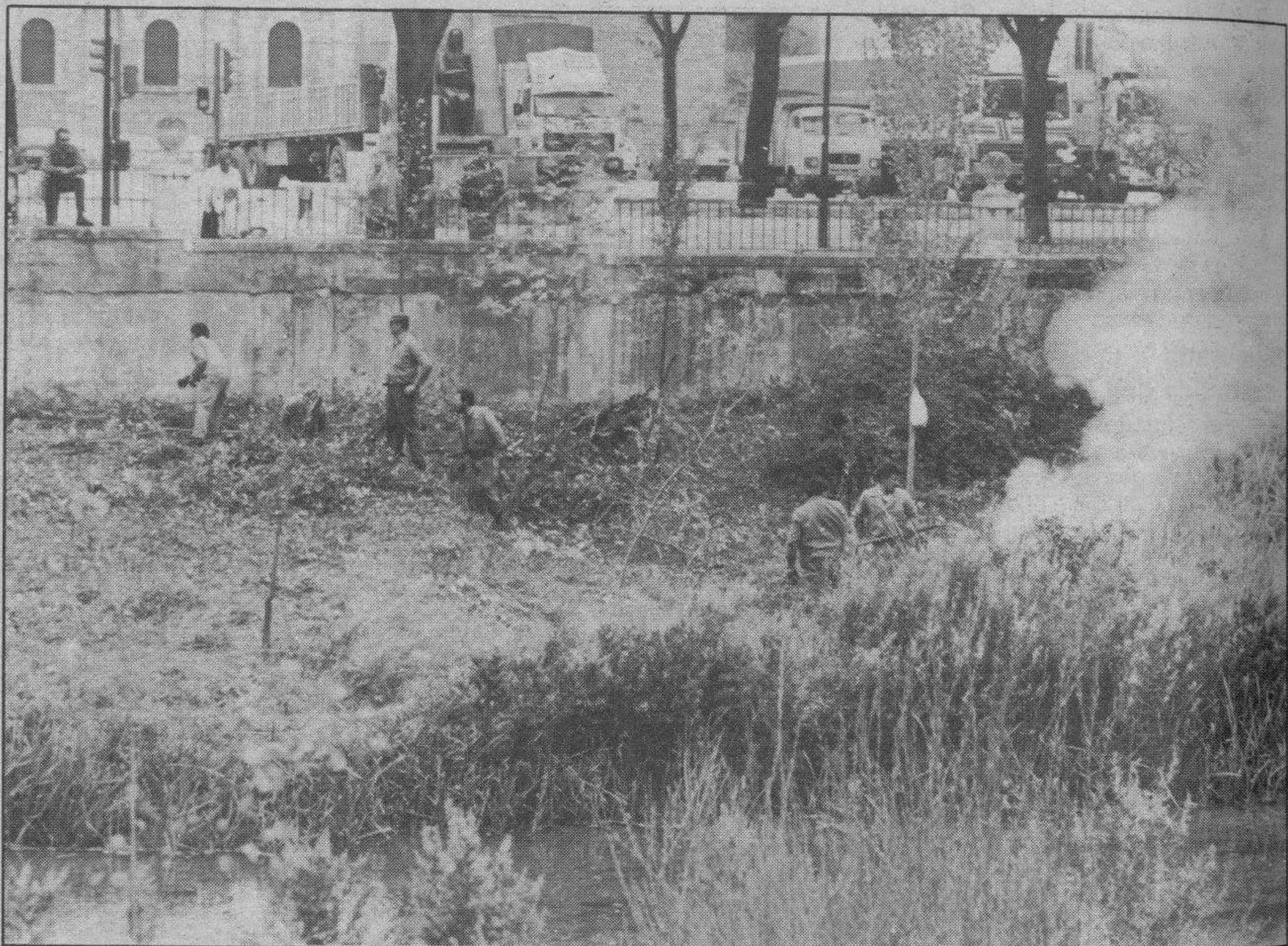
Limpieza de las márgenes. —Ciertamente un año de sequía y vegetación reclamaba una limpieza. Esta se realiza estos días para evitar que las orillas del Arlanzón se conviertan en basurales. La fotografía nos muestra las labores que se llevan a cabo en nuestro río mayor.
