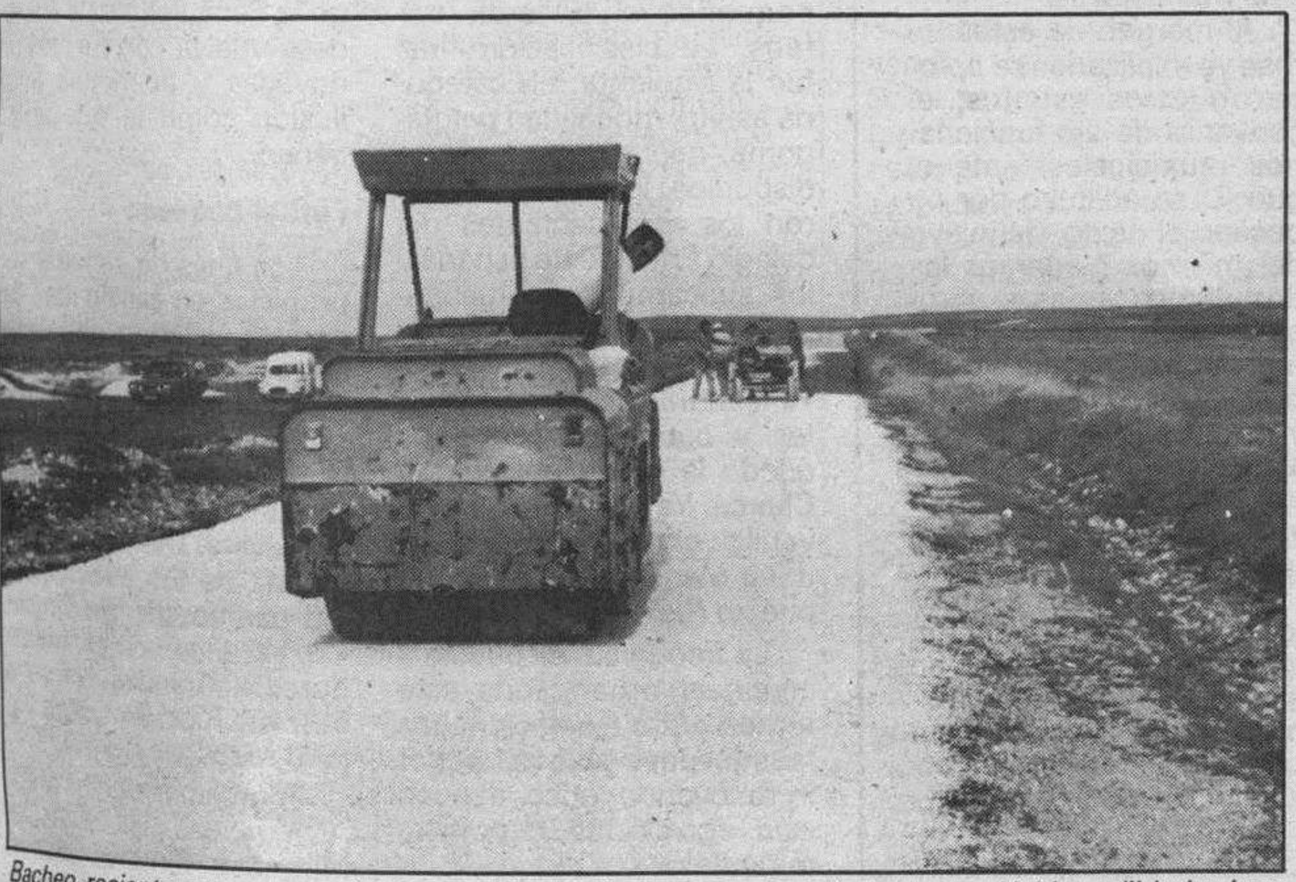
Bacheo reciente por cuenta del Ayuntamiento de Sargentos en la carretera Valderredible-La Lora.
