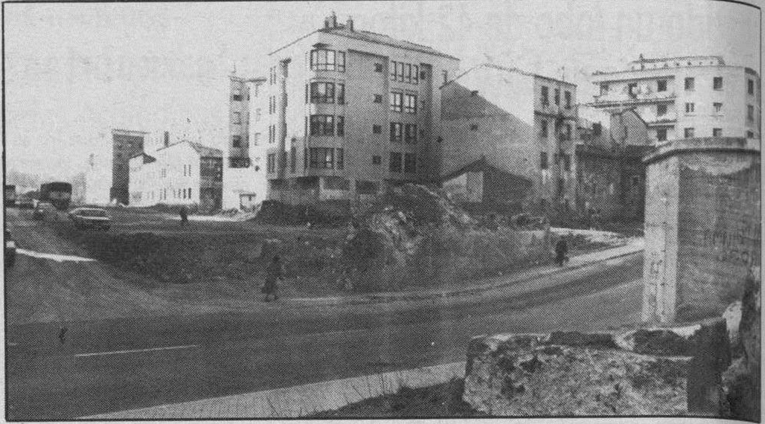
varán a lo largo del trazado urbanístico. Y ya son muchos los edificios asentados a los lados de esta futura e inmediata gran vía que hace muy poco tiempo nos parecía un sueño y que ya es una auténtica realidad. El desmonte, ya ha comenzado y, para septiembre se espera que la urbanización vital haya terminado. Truchuelo nos ofrece dos aspectos del estado de las obras, en uno de ellos se puede apreciar el cruce de la calle del Arenal, en el que estaba el llamado Puente de Ocaña y, asimismo, a la derecha se puede observar la diferencia de altura entre dicha calle y el trazado ferroviario
