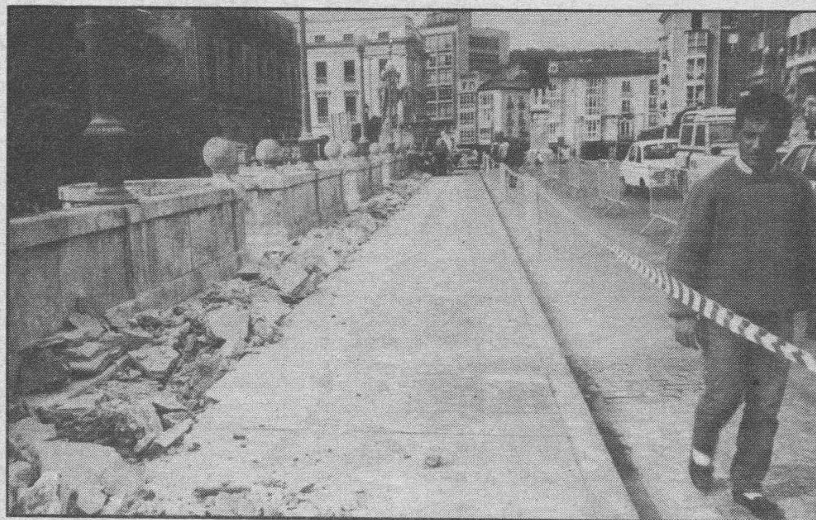
Esta es la acera afectada por la avería en el puente de San Pablo.
