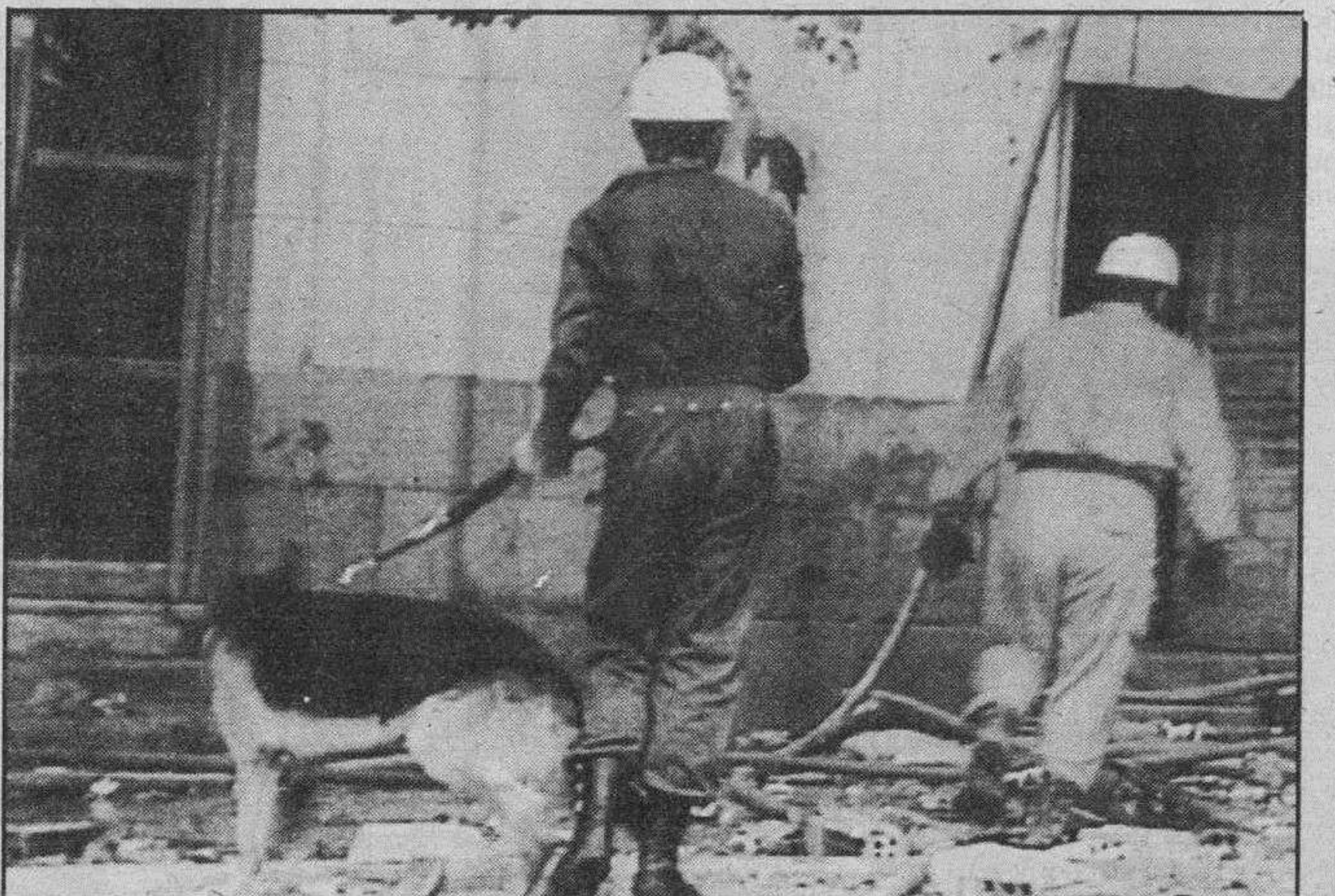
Las fotografías muestran las tareas de rescate de los ocho bomberos que continúan sepultados entre los escombros de los «Almacenes Arias».
