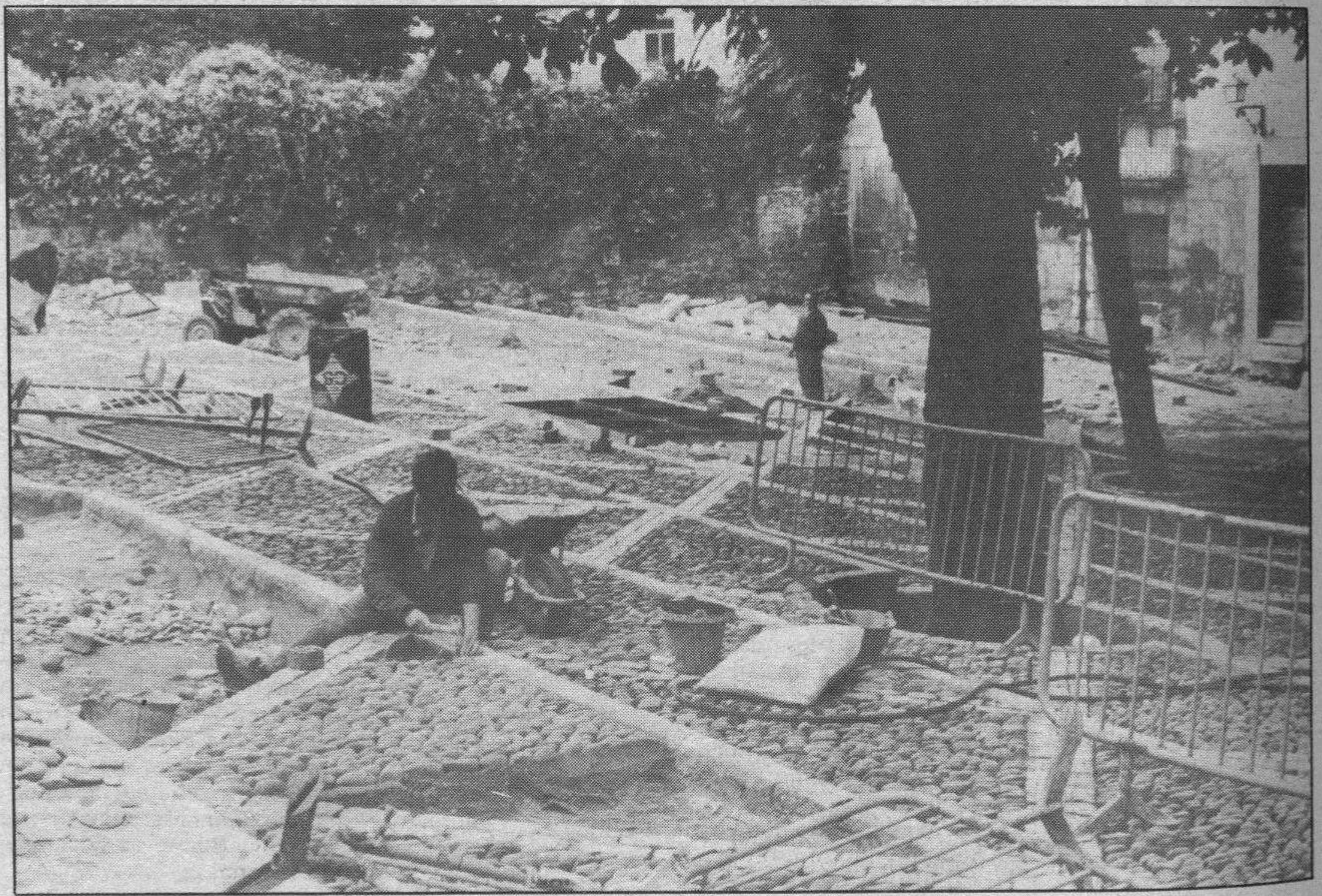
Las obras de la Plaza de los Castaños. — Avanzan los trabajos de pavimentación con arreglo al estilo tradicional del casco antiguo de la ciudad, la Plaza de los Castaños, en la calle de Fernán González, arteria principal de la Burgos de siglos pasados. La fotografía muestra con cuanto esmero se ejecutan estas obras que fueron paralizadas con el hallazgo de los restos de la iglesia de San Llorente, que quedaron definitivamente debajo.
