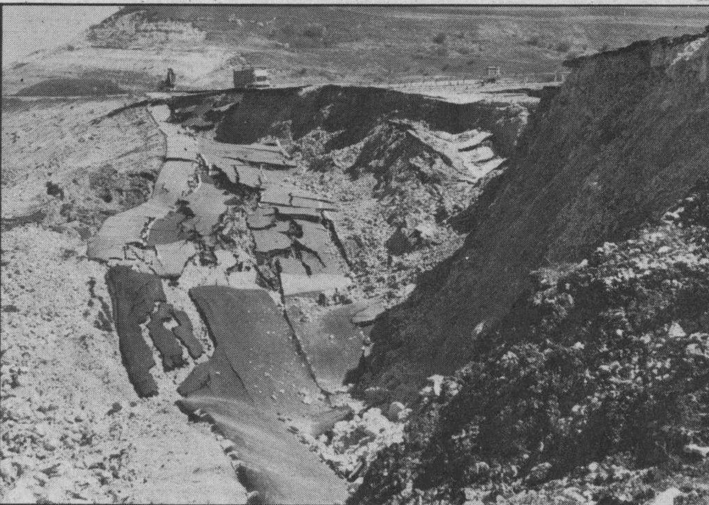
La fotografía muestra la espectacularidad del hecho al ceder la calzada.
