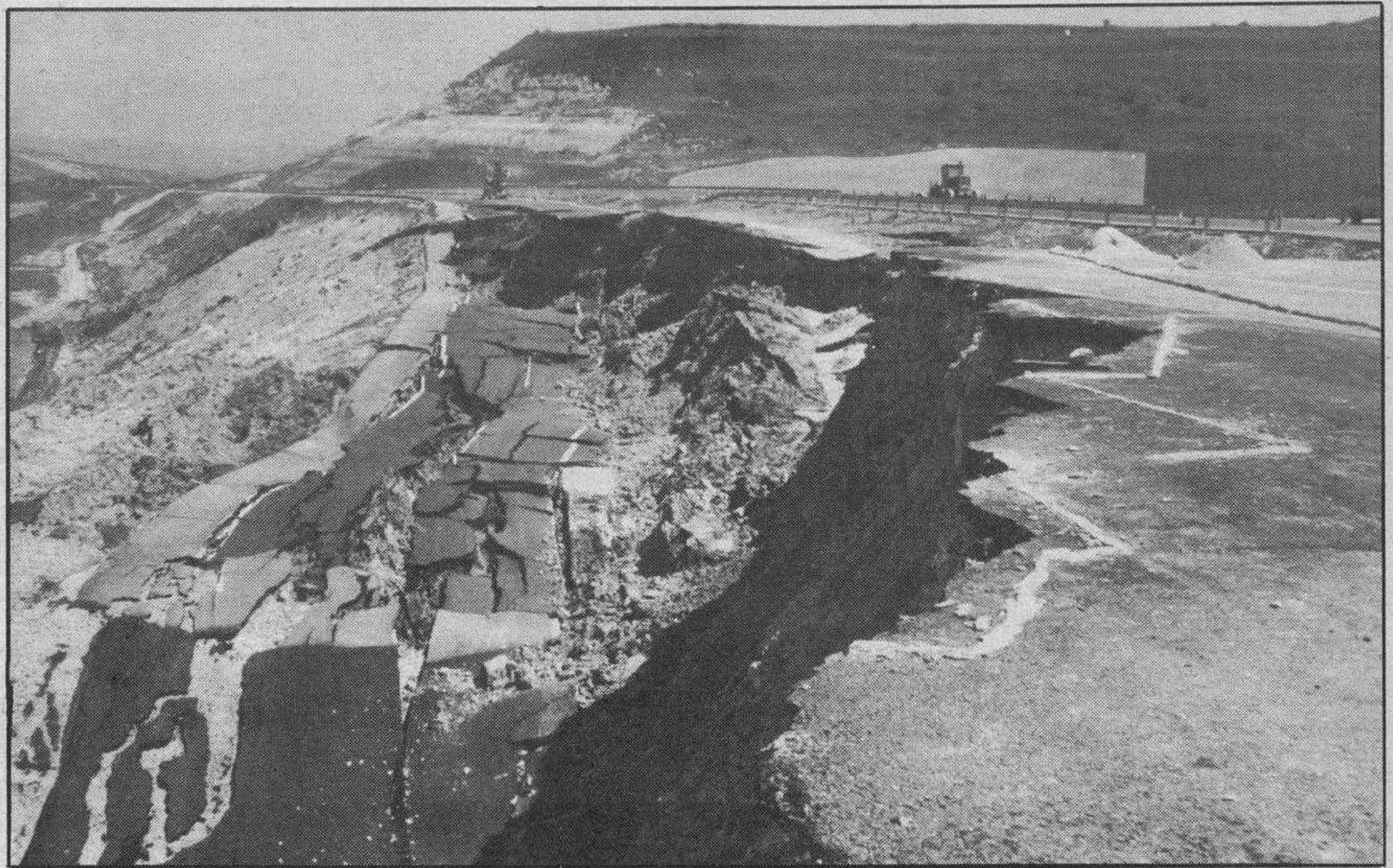
Se hunde un tramo de la Autopista en «La Brújula». — Se ha registrado un espectacular corrimiento de tierras en la autopista Burgos-Málaga, en el término de Monasterio de Rodilla. Un tramo de unos doscientos metros de la dirección que viene desde Bilbao a Burgos se hundió al ceder el terreno. El aspecto que ofrece esta vía de circulación se asemeja al de un seísmo. La empresa concesionaria ha tomado toda clase de medidas para desviar el tráfico, se ha señalado convenientemente y las obras se han iniciado para reparar el socavón monumental que se ha producido. No ha habido víctimas.
