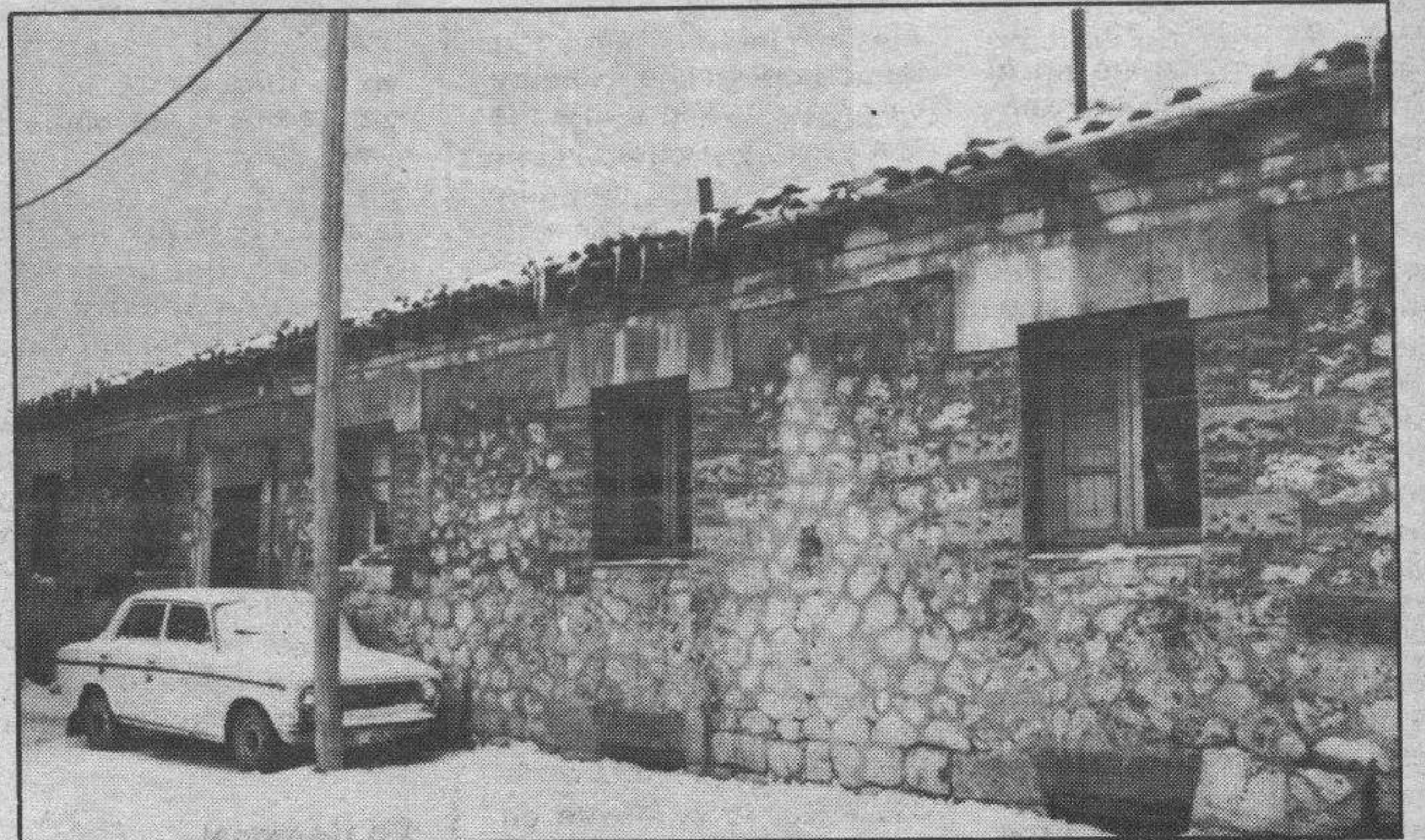
Esta es la casa donde malviven las tres familias gitanas. La construcción, aparentemente sólida en su fachada, encierra una estructura ruinoso y que amenaza con derrumbarse sobre sus moradores.
