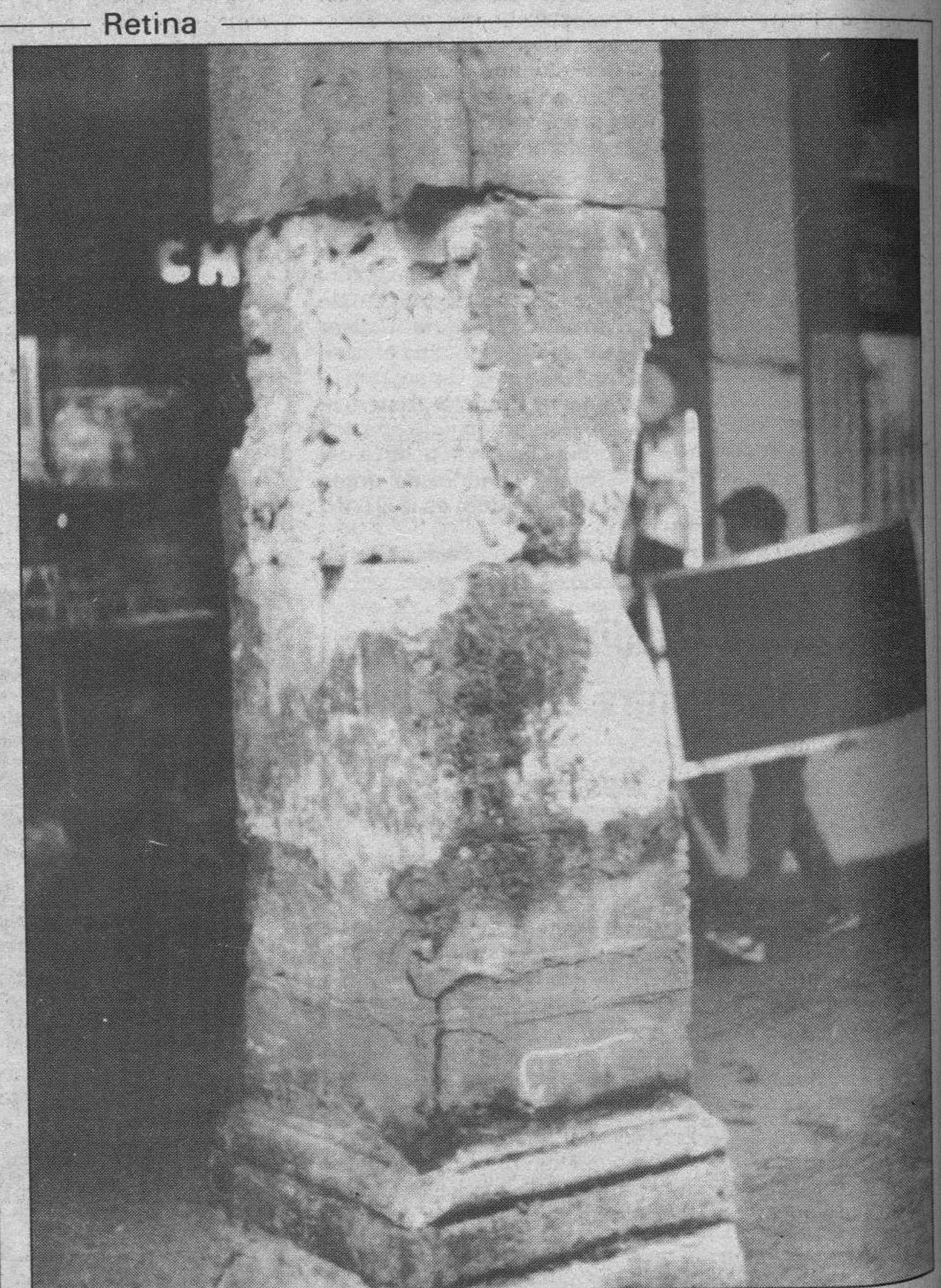
Columnas muy deterioradas. — Esta es una de las columnas de los soportales de la calle de la Paloma. Parece que su estado es bastante deficiente y, acaso, pudiera entrañar algún peligro para las edificaciones. Un lector nos repite este testimonio gráfico que, indudablemente, es de interés y actualidad.
