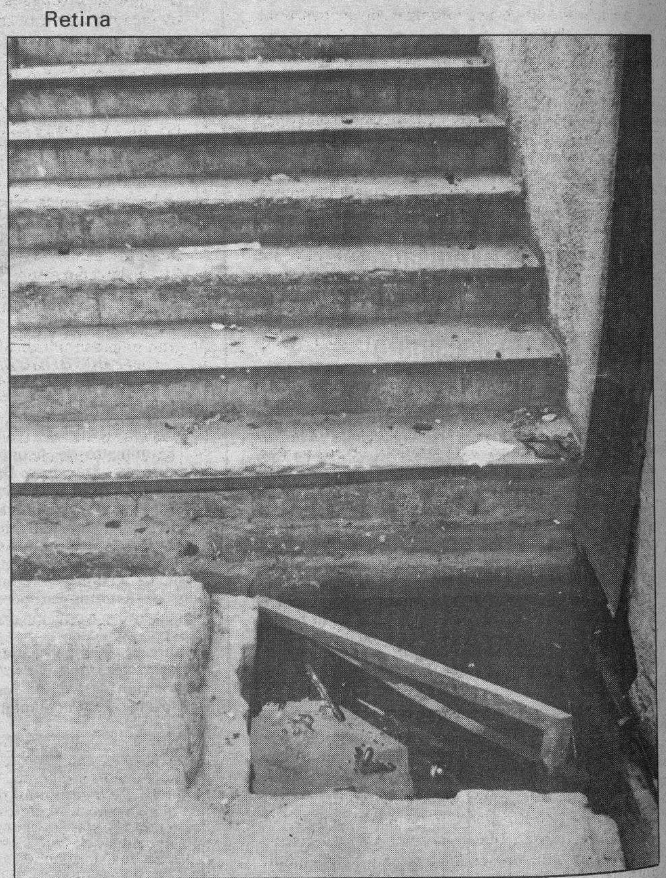
Un paso peligroso para peatones. — EL paso subterráneo de la calle Santa Dorotea, por rechazo de los peatones, por el estado en que se encuentra habitualmente —cuando no inundado— o por los riesgos que ofrece, miedo de quienes lo utilizan a cualquier asalto de delincuentes u otras causas, no es utilizado y está condenado a ser inútil. A todos esos inconvenientes hay que añadir ahora esté de la alcantarilla sin tapa con el consiguiente peligro para niños o personas de edad. Una pena, vamos.
