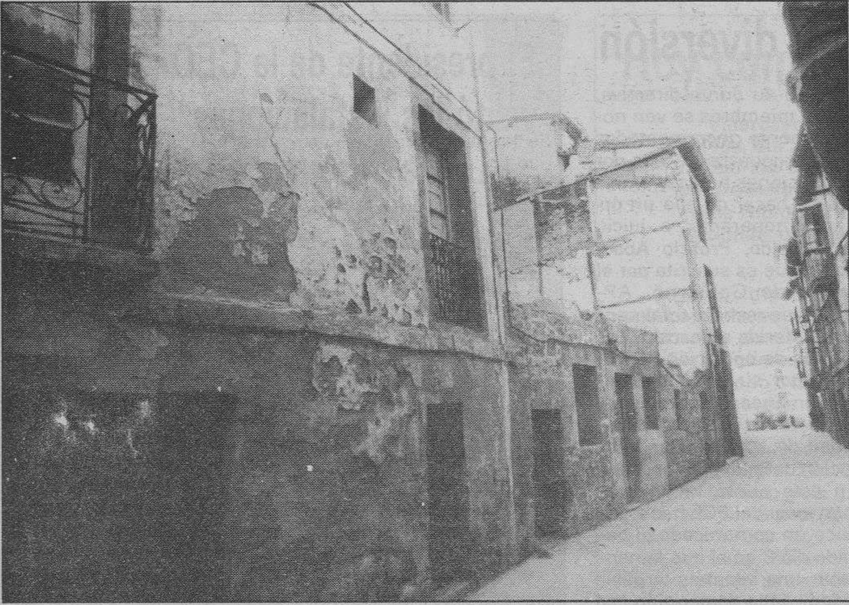
La mayor parte de los edificios de la calle Los Hornos son irrecuperables
