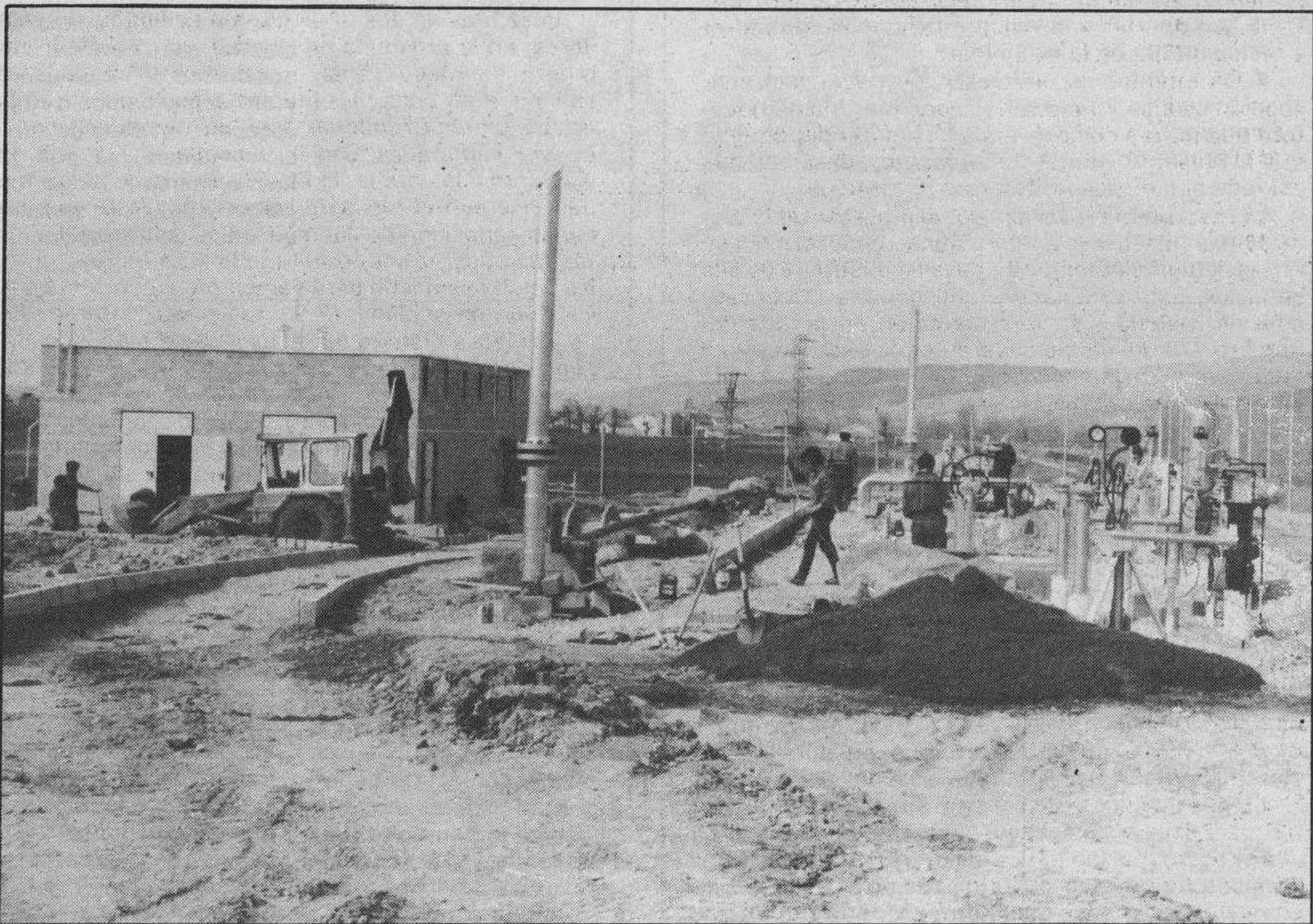
La central de Enagás.— Estas son las obras de la central de la Empresa Nacional del Gas en nuestra ciudad, concretamente en el polígono de Villalonquér. Otra se emplaza en el de Gamonal. Todos los temas del gas interesan en este momento ante la llegada del suministro a nuestra ciudad a través del ya en funcionamiento gasoducto Haro-Burgos.
