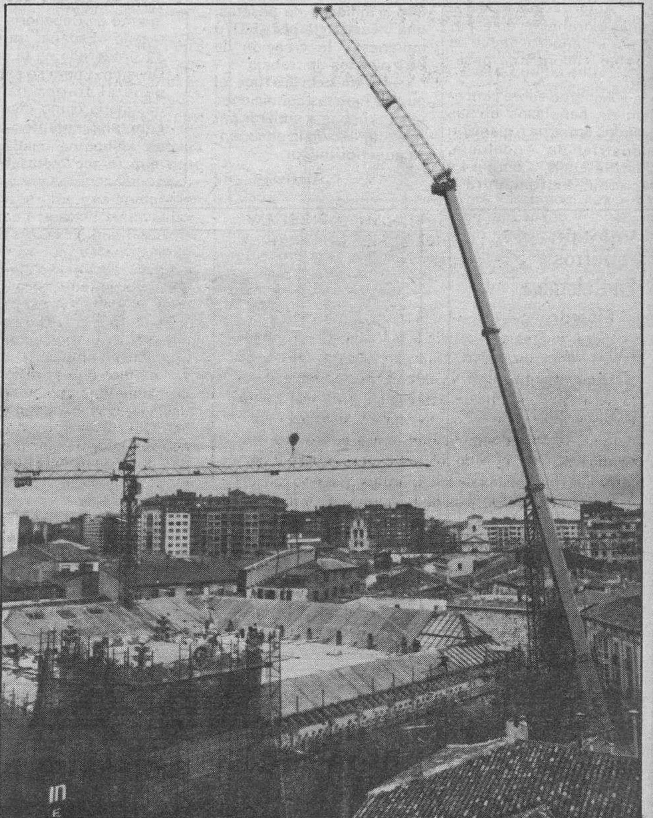
Espectacular. — En nuestra edición anterior recogíamos las primeras fotografías de los trabajos que lleva a cabo estos días la gigantesca grúa de las obras de la Casa del Cordón. Hoy, desde otra perspectiva, la cámara fotográfica ha captado en toda su dimensión la espectacularidad de esta operación que pasará, lógicamente, a la historia gráfica burgalesa de este tiempo.
