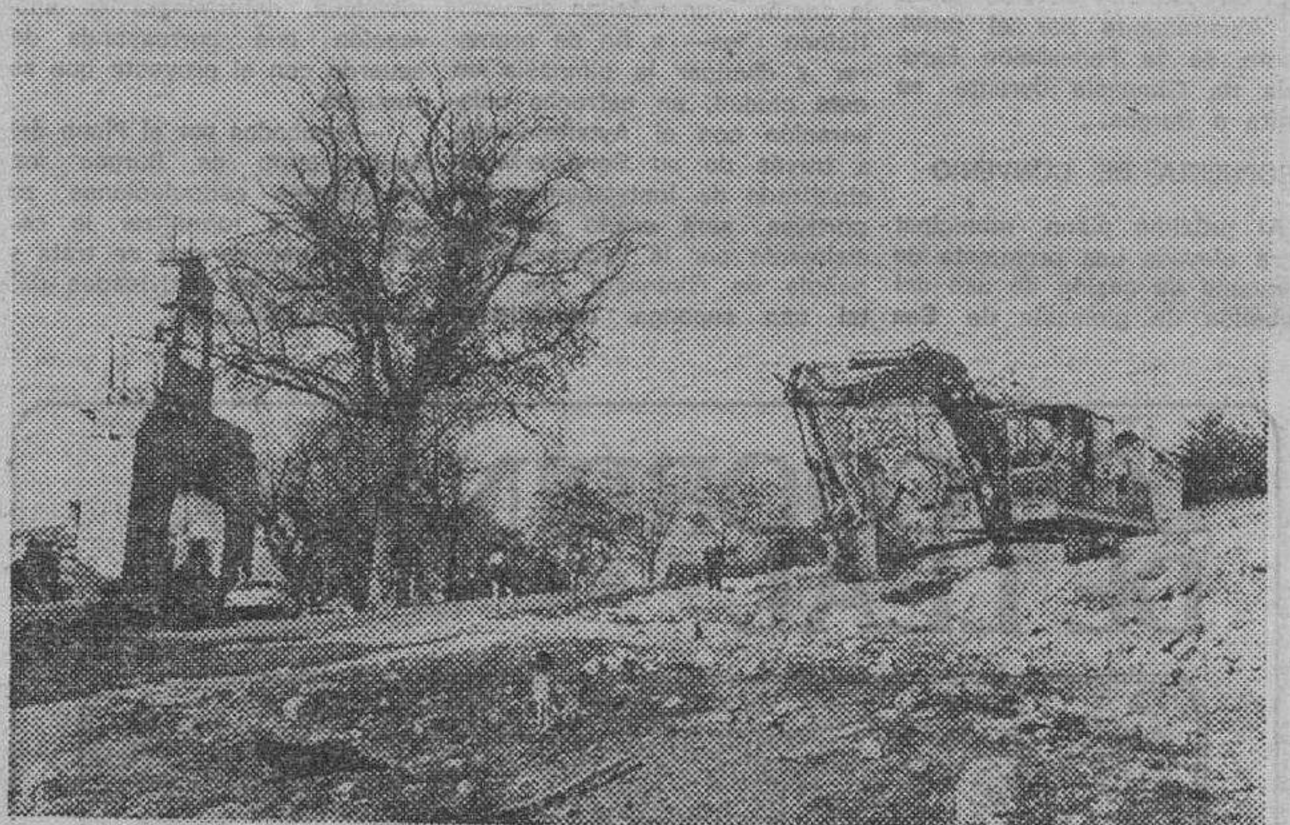
Trabajos de explanación y mejora del entorno del Arco de Fernán González.—(Foto FEDE).
