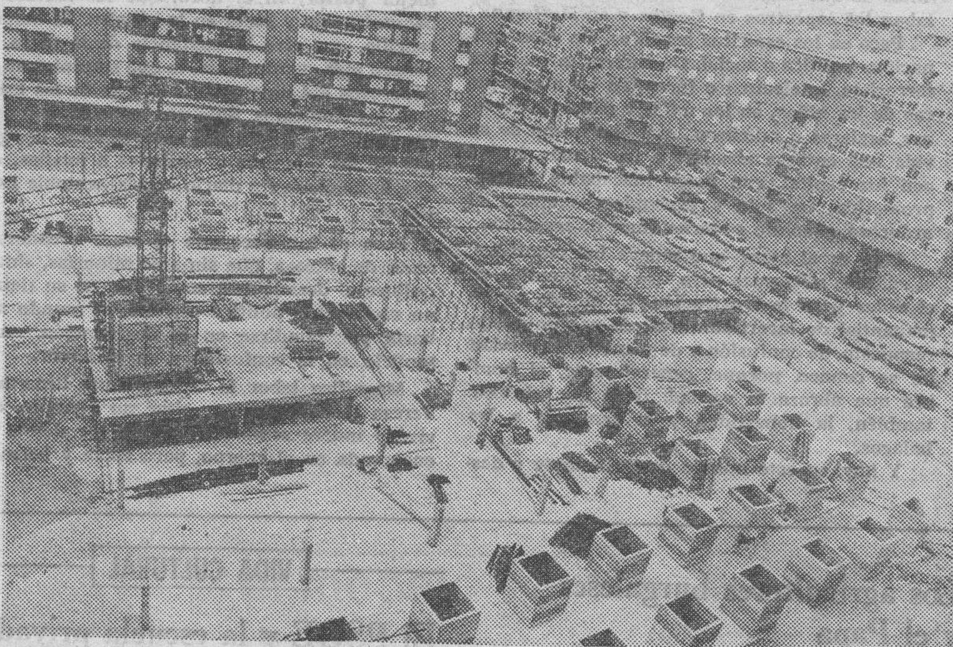
El alcalde de la ciudad ha visitado en las últimas horas las obras de construcción del aparcamiento subterráneo de la Plaza de Santiago que lleva a cabo la Sociedad Municipal de Aparcamientos. En la fotografía de Fede se ve una magnífica perspectiva de estas obras, antes de la cobertura del aparcamiento.
