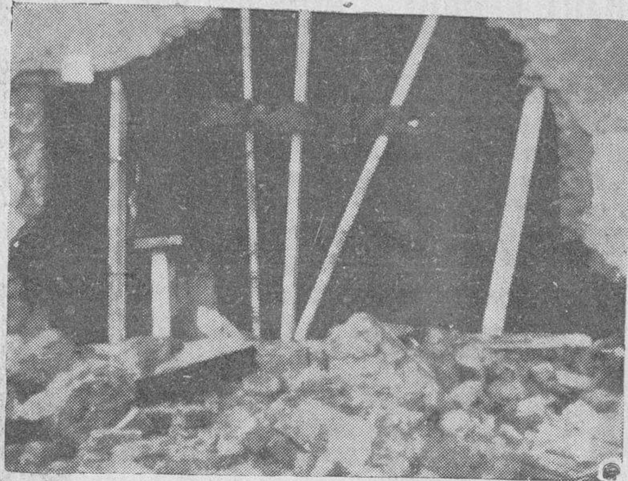
Las constantes lluvias han venido causando algunos daños, en especial en casas modestas en construcción, por reblancamiento de adobes. En la calle Larga del Arrabal del Puente se ha registrado últimamente el derrumbamiento de la casa número 2, a la cual pertenece la fotografía que publicamos, de una de las paredes que mayores daños han sufrido.—Foto Almaraz
