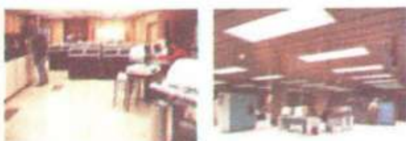
Vista del distribuidor del Registro de la Propiedad Industrial, con las unidades de disco al fondo. Aspecto de la planta donde está instalado el distribuidor de los PUNTOS DE INFORMACIÓN CULTURAL (PIC).
