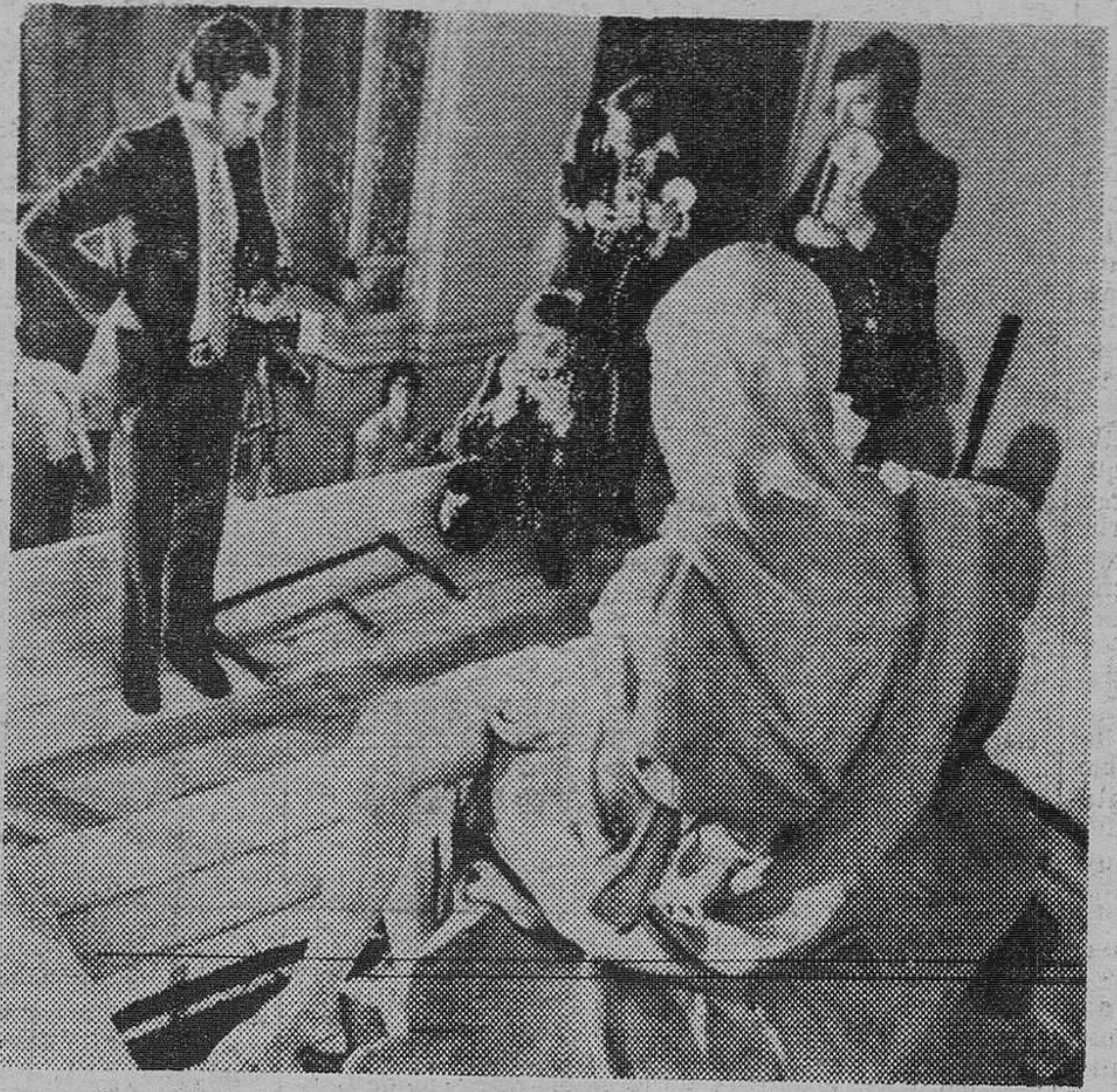
Los fotógrafos, sobre el andamiaje instalado en torno a la obra maestra de Miguel Angel, «La Pietá», toman fotos de la famosa estatua en la Basílica de San Pedro. El andamiaje fue colocado para que los artistas restauradores puedan iniciar la reparación de los daños ocasionados por Laszlo Toth a la estatua, el pasado día 21. — (Teléfoto Cifra Gráfica-UPI)
