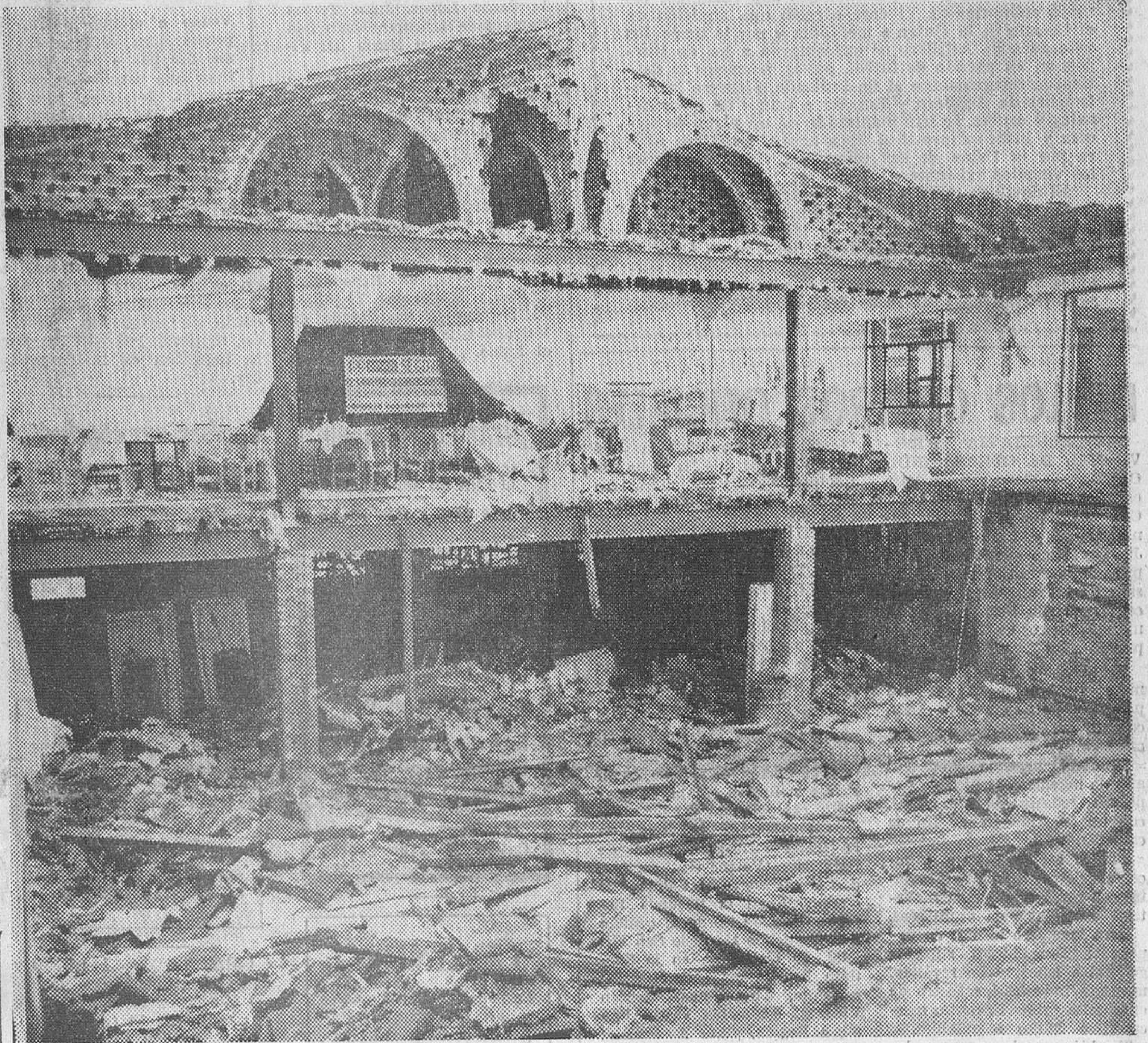
Aspecto que presentaba el edificio después del hundimiento. — (Foto CIFRA)
