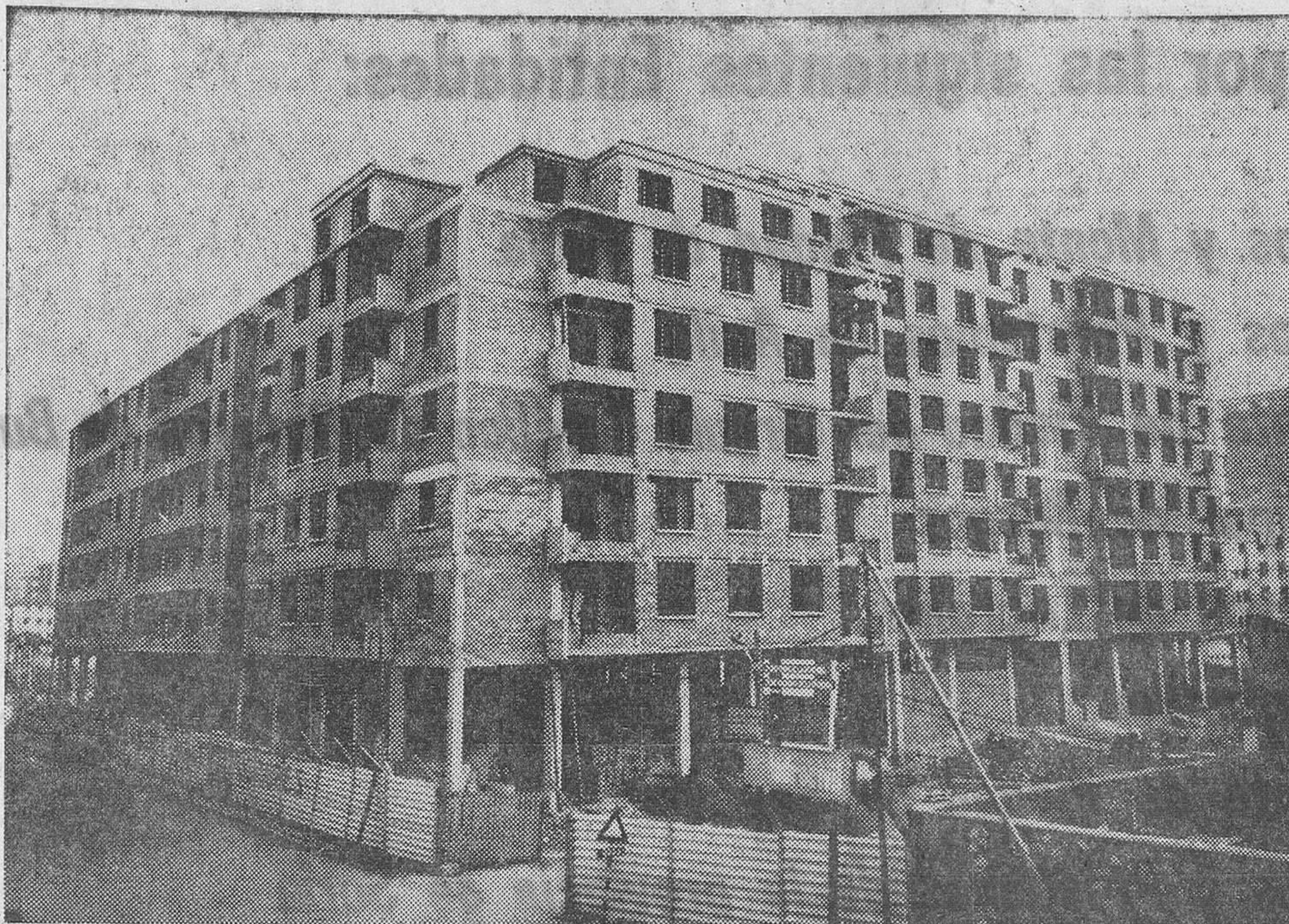
Estado actual de las obras de construcción de los bloques de viviendas que la CAJA DE AHORROS MUNICIPAL está levantando en la calle de Las Calzadas, dentro del Plan "Diaz Reig". — (Foto "Fede").
