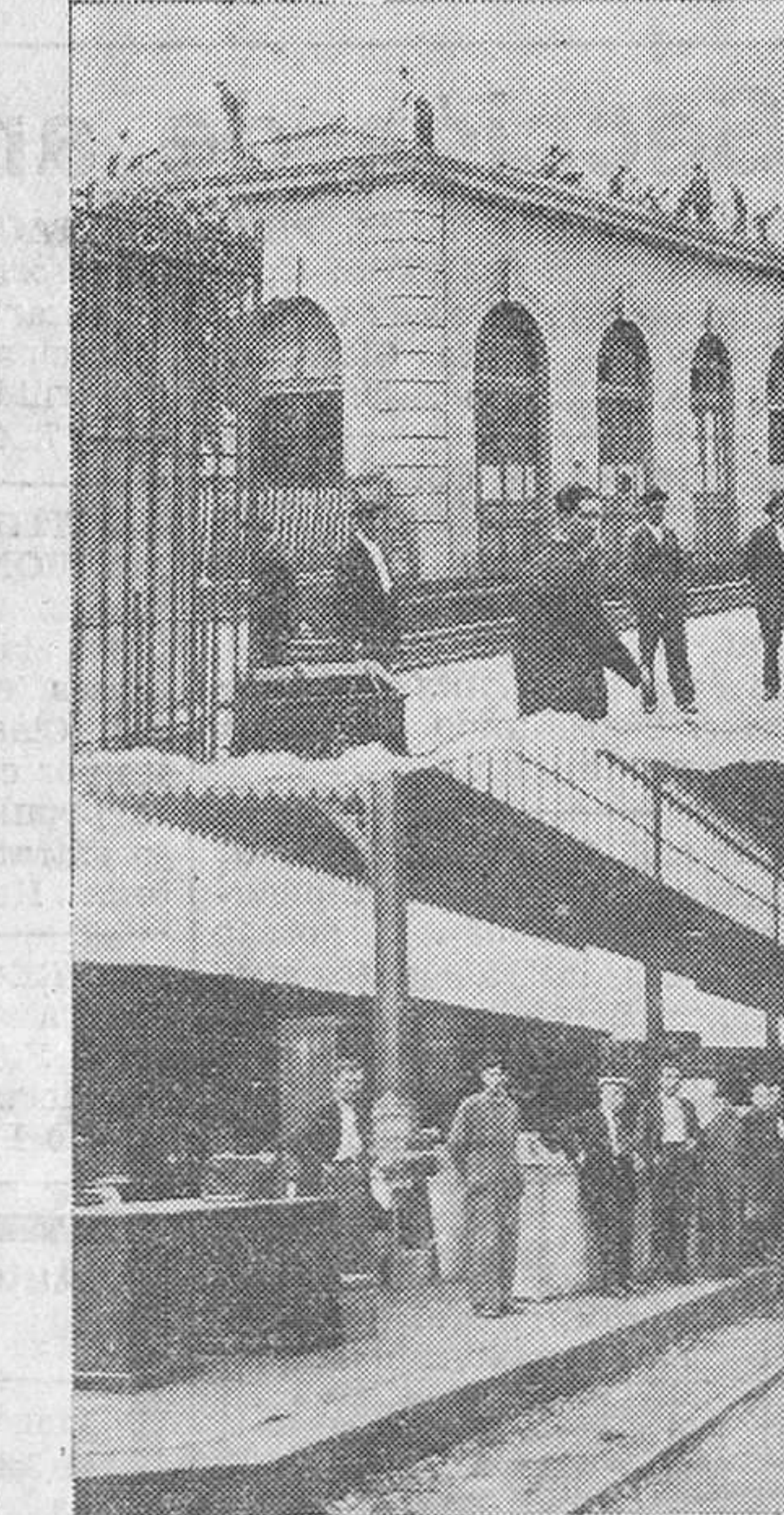
LOS DERRIBOS DE LAS ESTACIONES. — La que era mangible estación del Norte ha comenzado a venirse al suelo bajo los efectos del incessante trabajo de los obreros que están en el tejado. — En los andenes se amontonan los muebles de las oficinas. — (Fotos Samot.)
