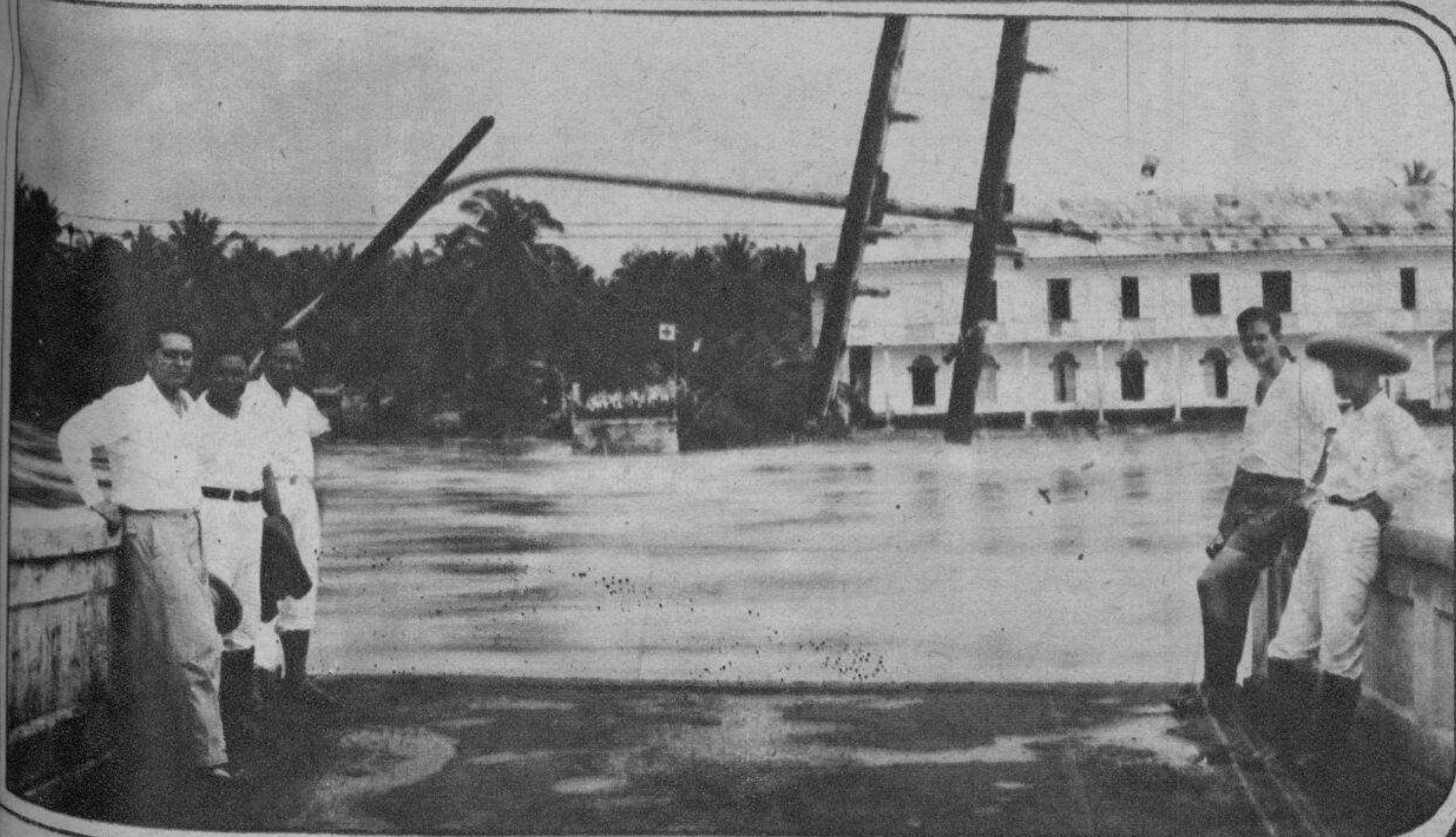
El puente de Calmay, uno de los más largos y más importantes de Pangasinán, pues comunica Lingayen con Dagupan aparece aquí tal como quedó destruido por la inundación. Nótese el poste de teléfonos doblado.
