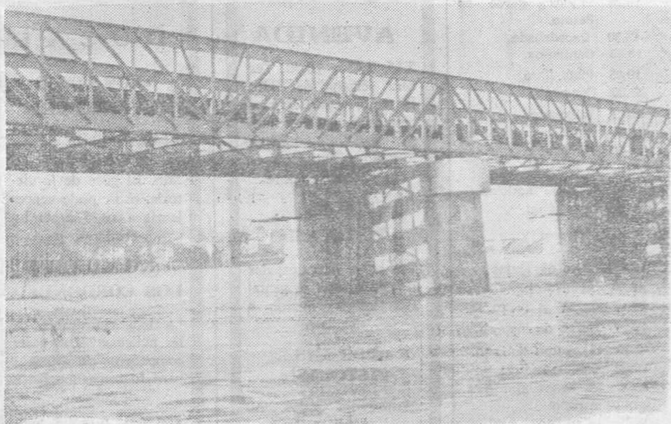
El denominado puente de hierro —de la línea de Rioja—, dejará de ser ferroviario para ser recuperado por la circulación peatonal y rodada.
