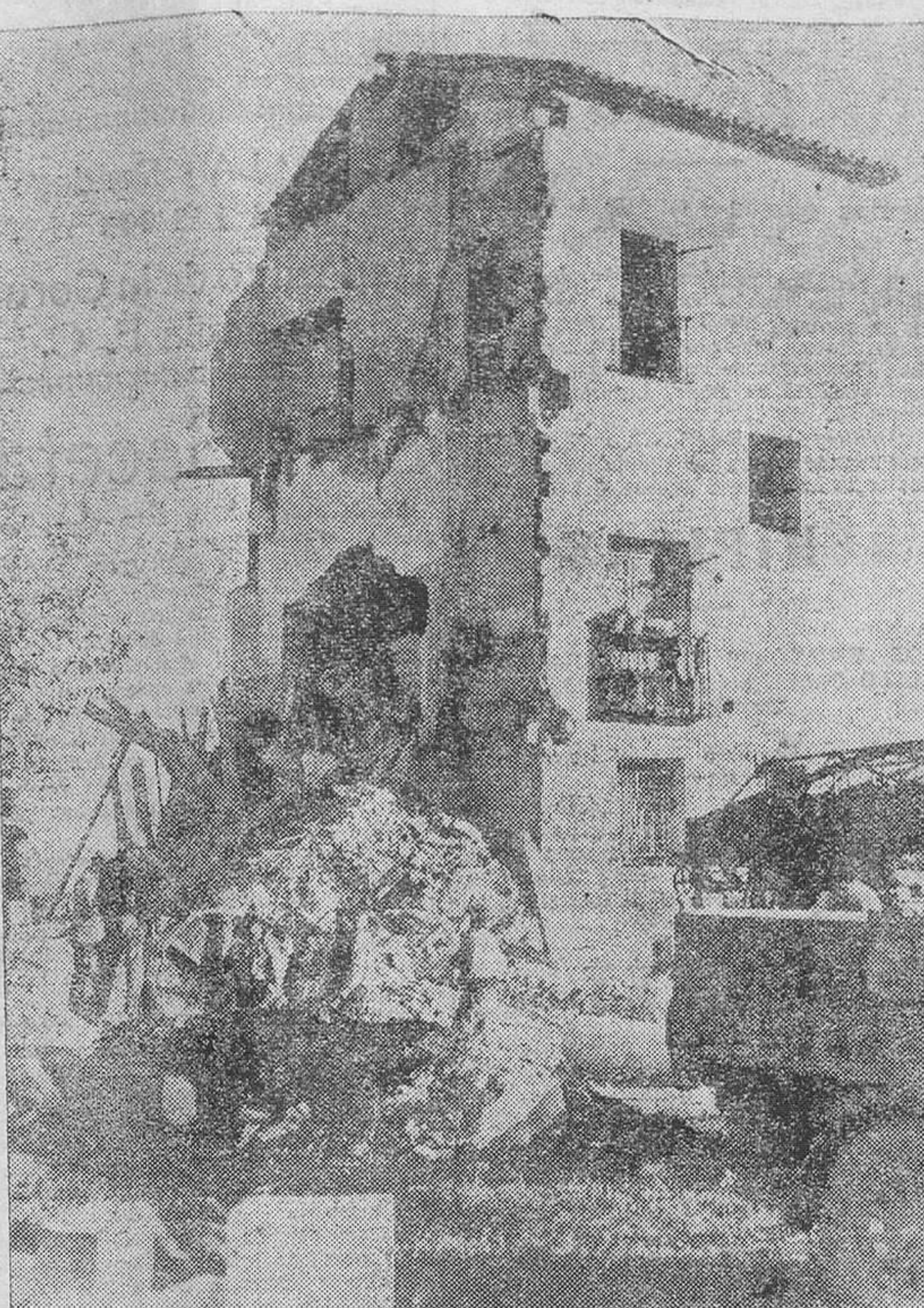
ESTADO EN QUE QUEDO LA CASA HUNDIDA
