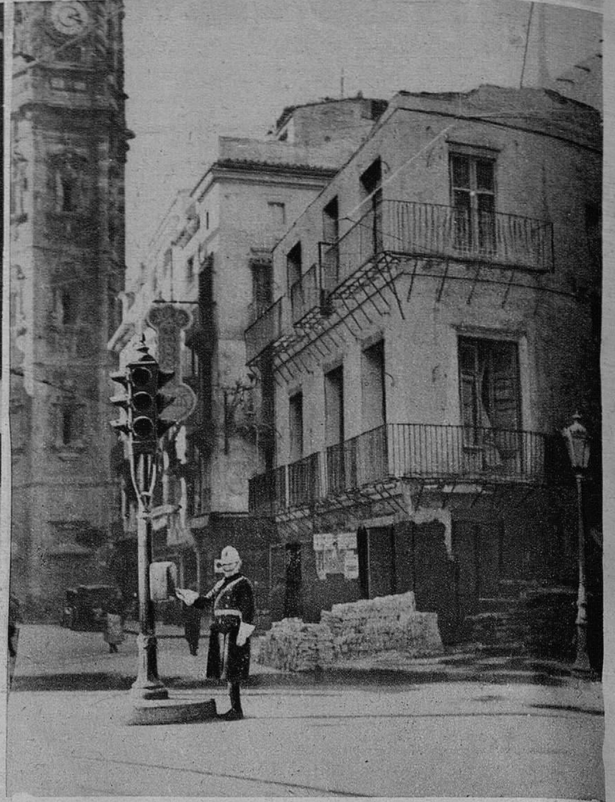
Han empezado las obras de la reforma de la plaza de la Reina. He aquí la primera casa que señala la ruta de los derribos.
