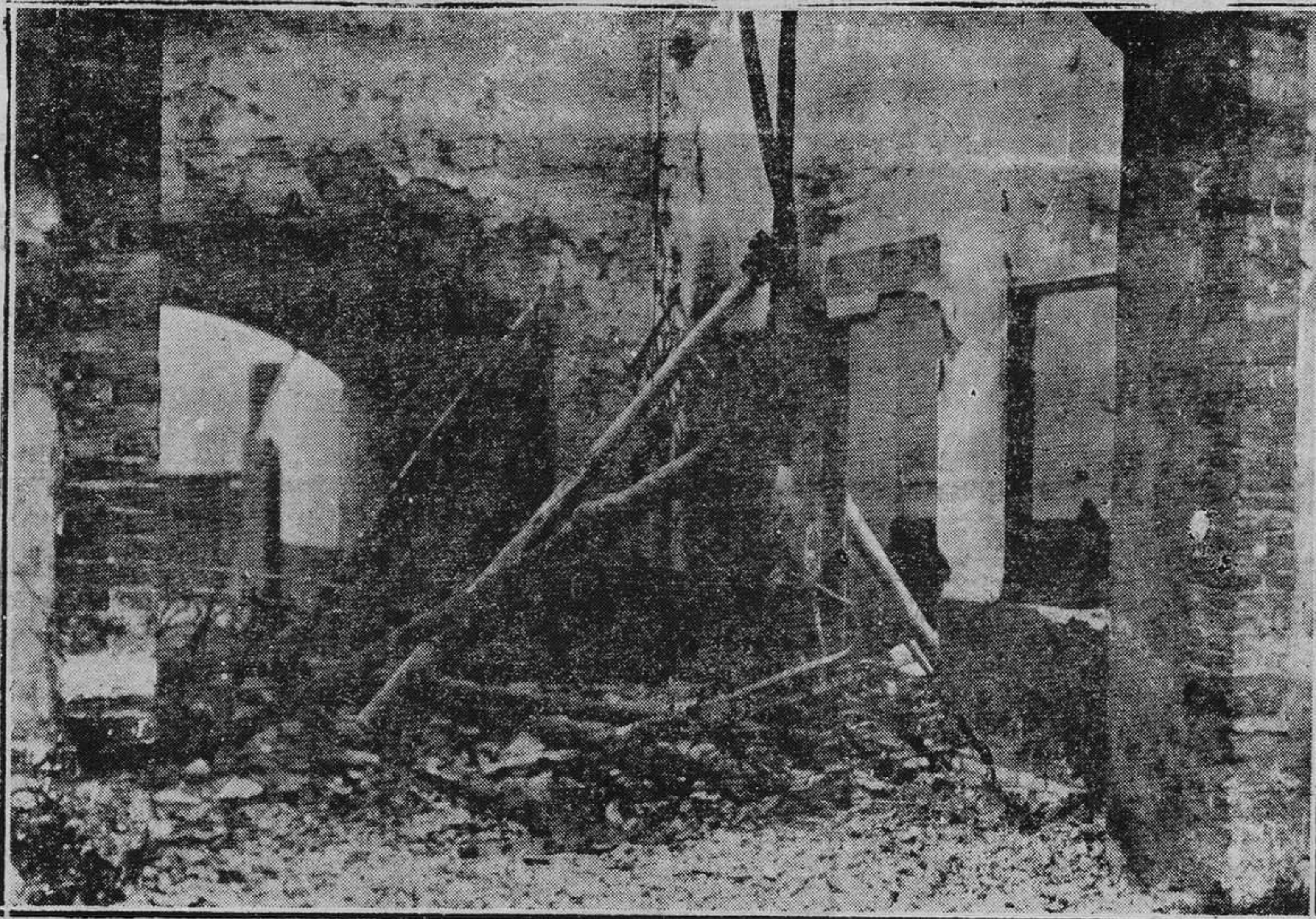
OVIEDO.—El patio de cuadrillas y la entrada a la enfermería después del incendio de ayer en la plaza de toros. (Foto Mena).
