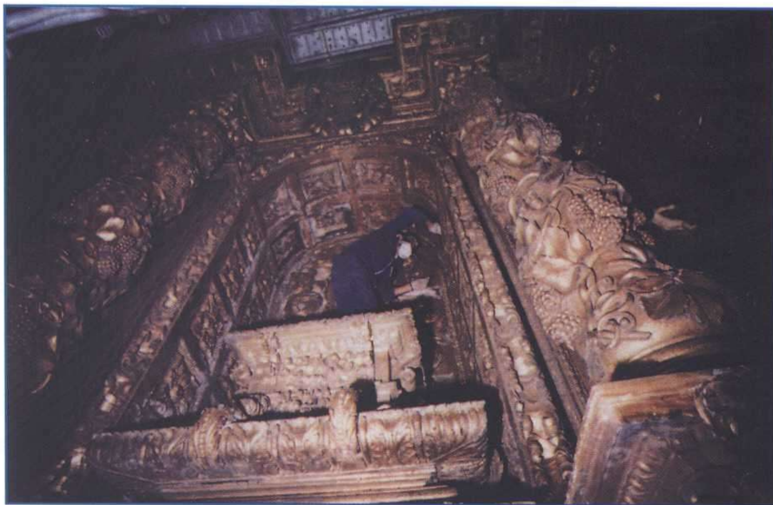
Las obras de recuperación del retablo de San Francisco Javier han ocupado una parte importante del proyecto
