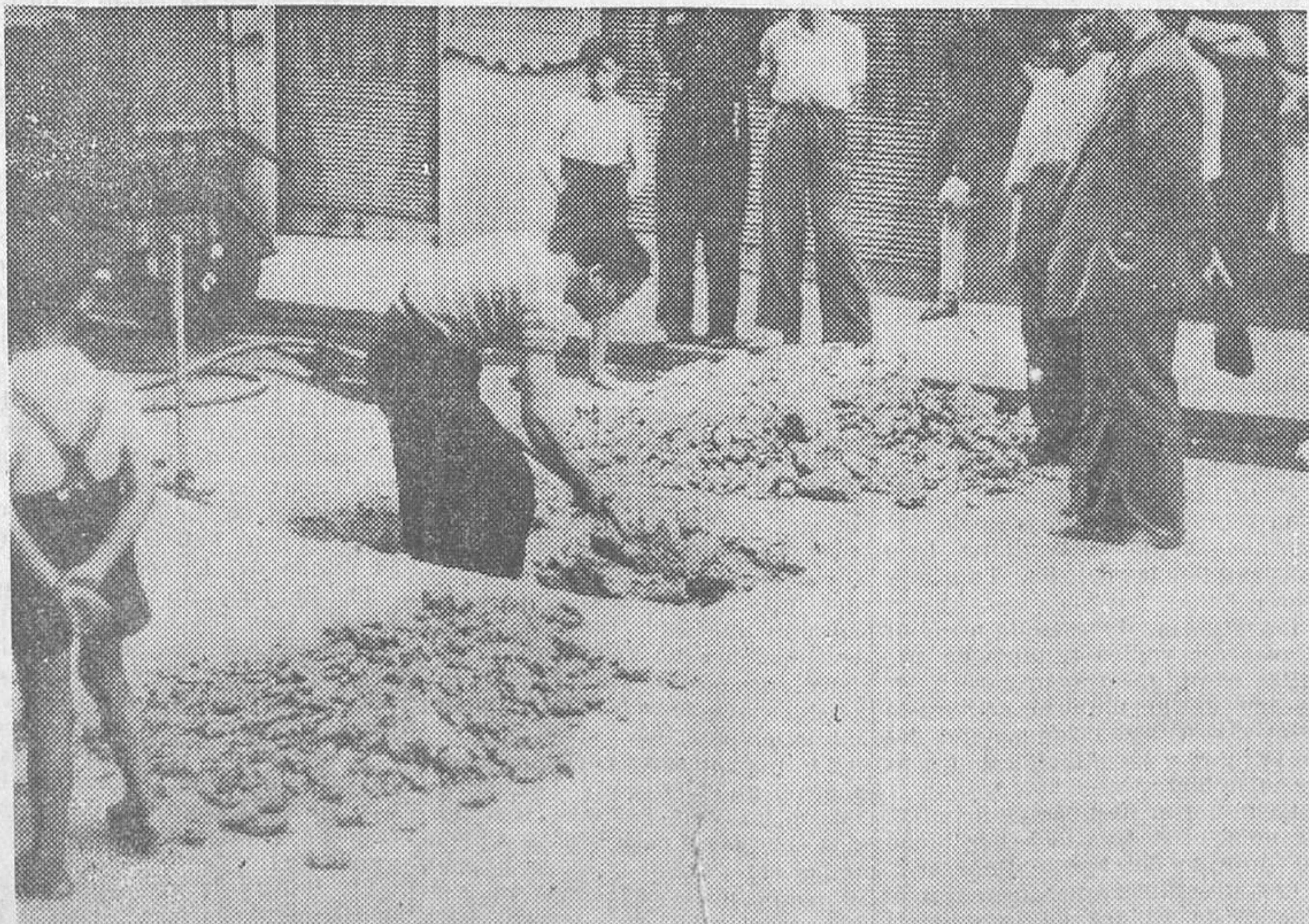
En la tarde de ayer dió comienzo en Madrid la reparación de las averías de la conducción de aguas, obras que se hallaban suspendidas a causa de la huelga de la Construcción. (Fot. Alfonso.)
