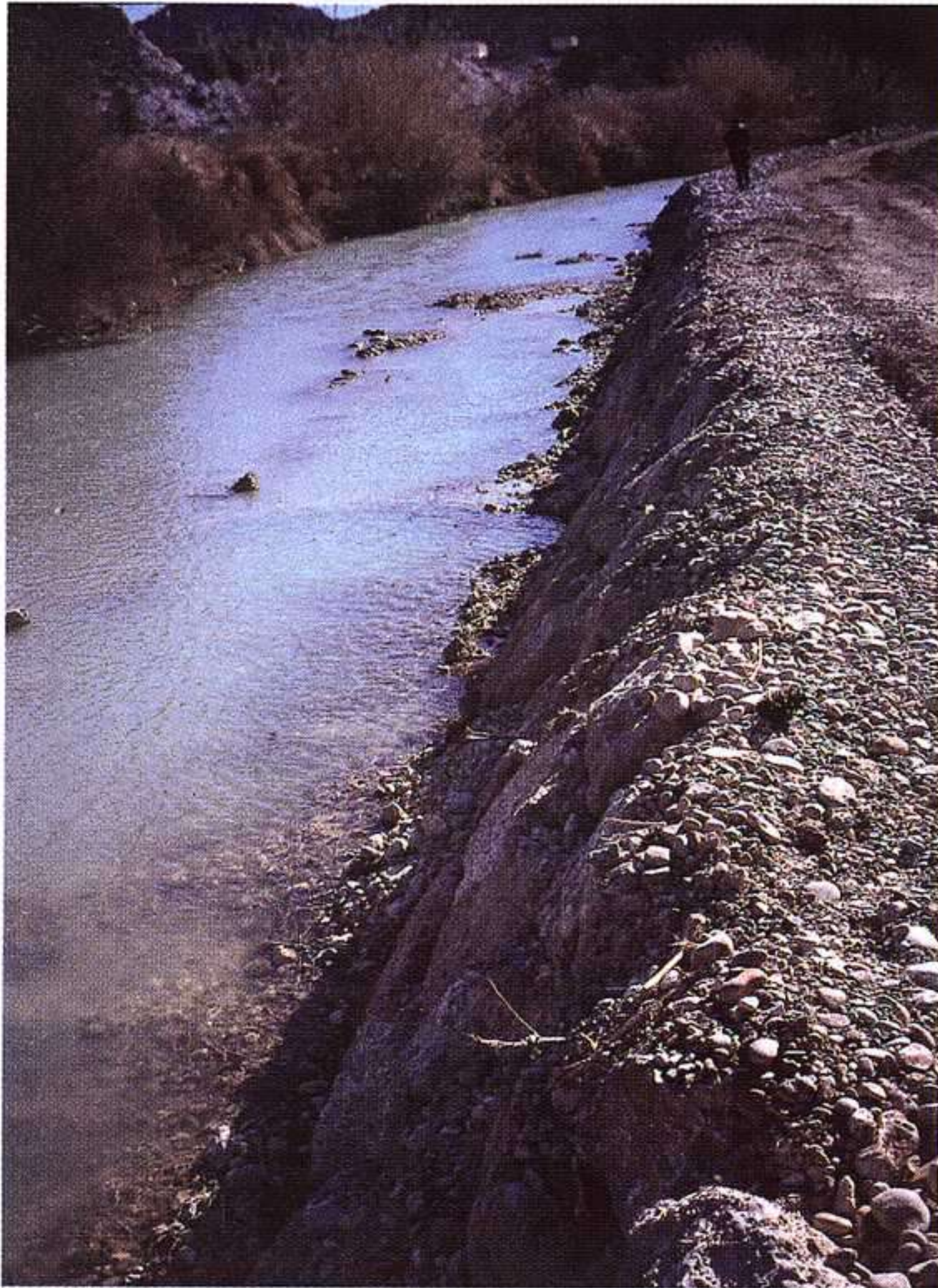
Dstrucción de la vegetación y márgenes en un LIC, aguas abajo del embalse del Cenajo. Foto: ECOLOGISTAS EN ACCIÓN-REGIÓN MURCIANA
