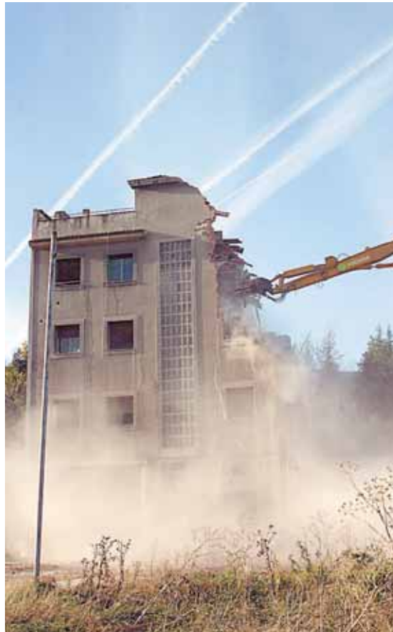
En algunos casos es necesaria la demolición de edificios preexistentes / J. MARTÍN
