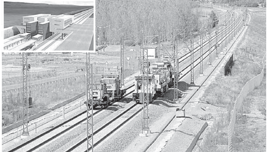
Catenarias del trazado de la línea de alta velocidad en la provincia de Segovia. Arriba, maqueta de la futura estación.
