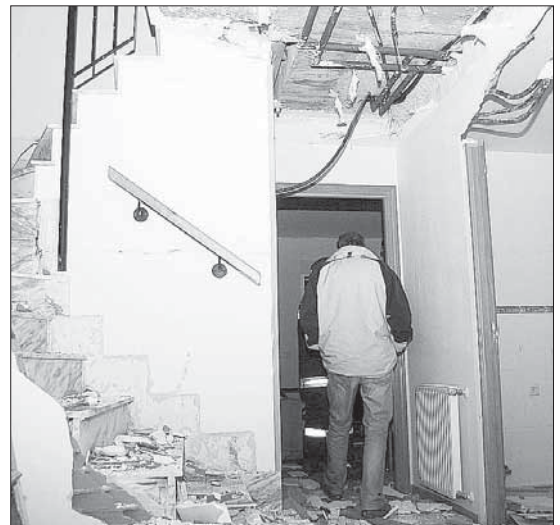
La explosión provocó numerosos daños, especialmente en la planta baja. / A.C.
