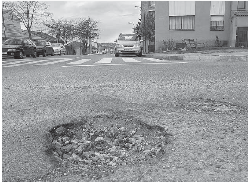
El Ayuntamiento destinará casi 60.000 euros a la eliminación de los baches existentes en la ciudad. / FERNANDO PEÑALOSA
