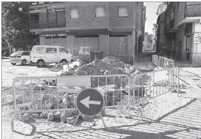
Las obras provocaron una avería que afectó a numerosos vecinos del barrio de San Millán/JUAN MARTÍN
