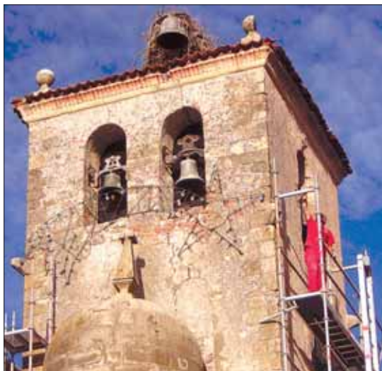
En los primeros días de trabajo se han colocado los andamios / ÁLVARO PINELA
