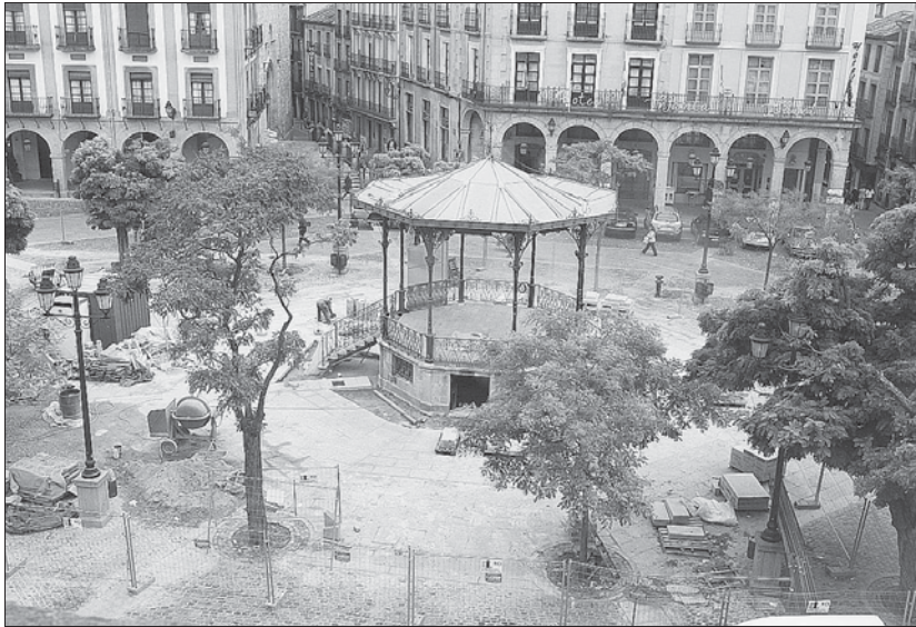
Las obras de la Plaza Mayor finalizarán antes de acabar el mes, según las previsiones municipales/FERNANDO PEÑALOSA
