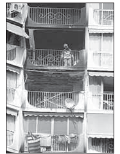
Estado del edificio quemado.
