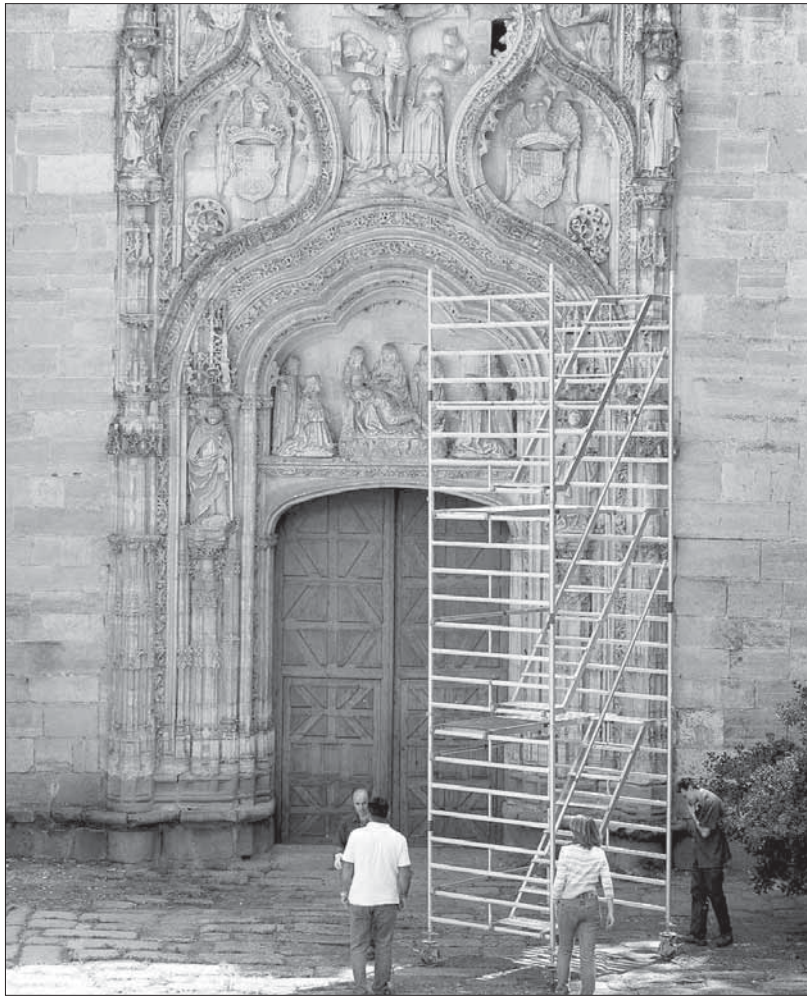
Los técnicos instalan el andamio con el que accederán a las zonas más deterioradas de la portada PEÑALOSA
