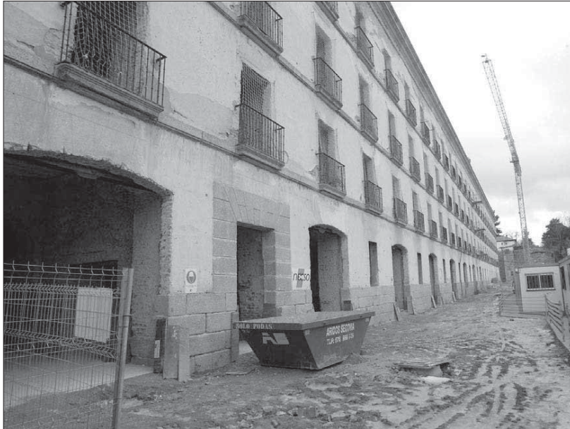
Unas 200 plazas del aparcamiento están destinadas al futuro Parador, ahora en obras
