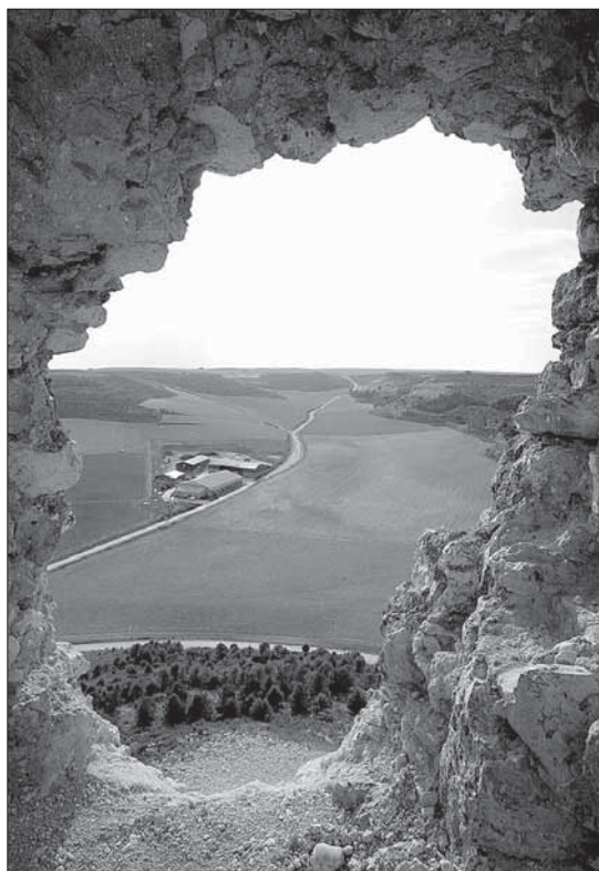
Obras de restauración del castillo de Curiel de Duero (Valladolid). / R.C. (ICAL)
