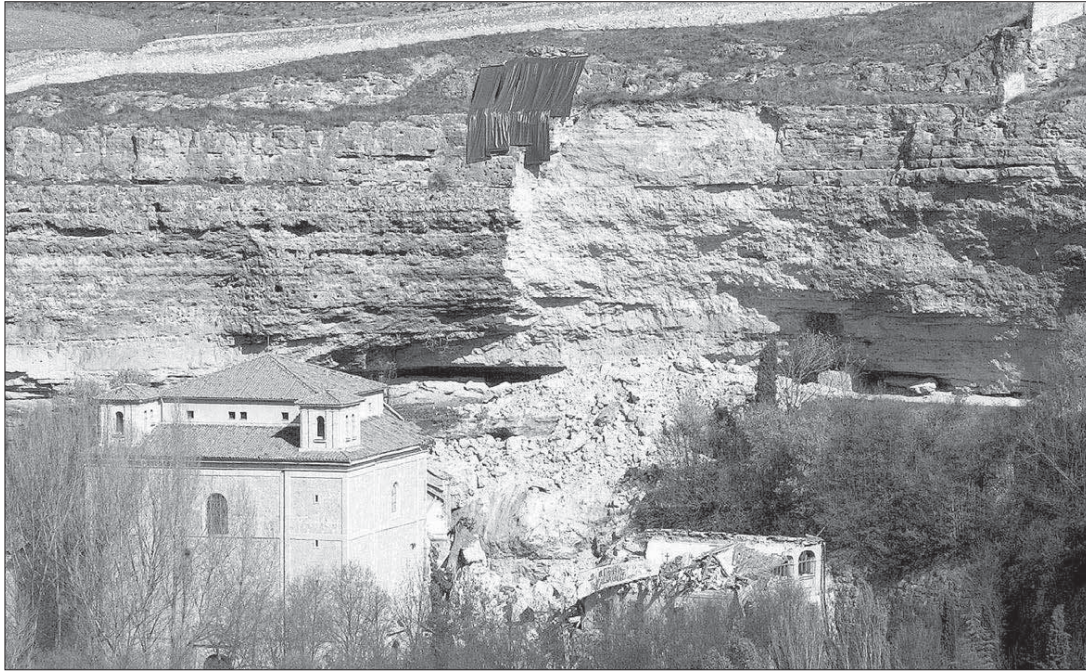
Imagen del estado en que quedó la zona tras el desprendimiento de unas 2.000 toneladas de roca el pasado jueves
