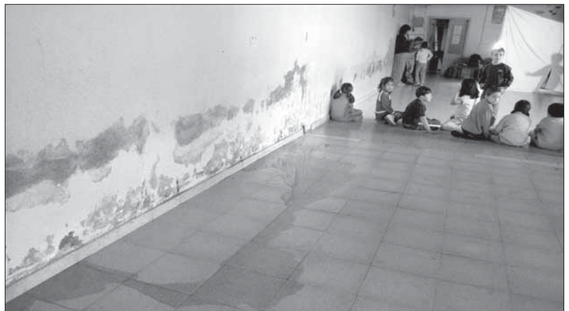
En el colegio Villalpando la humedad se ha filtrado por las paredes del gimnasio JUAN MARTIN
