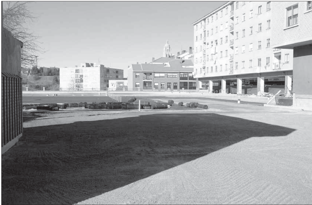
Aspecto que presentaba ayer la zona exterior de la estación de autobuses, que se encuentra prácticamente terminada
