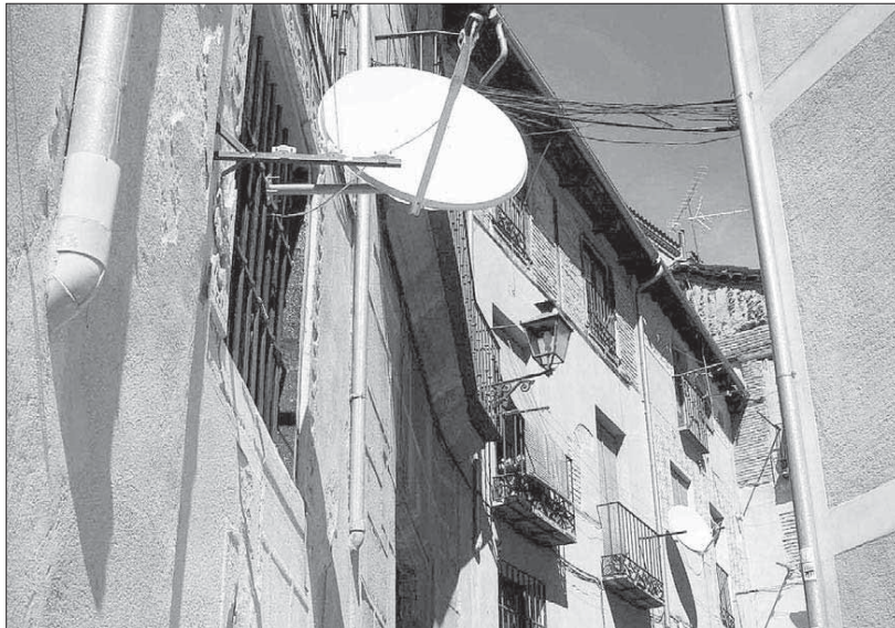
Las antenas colocadas en las fachadas deberán ser retiradas por sus propietarios
